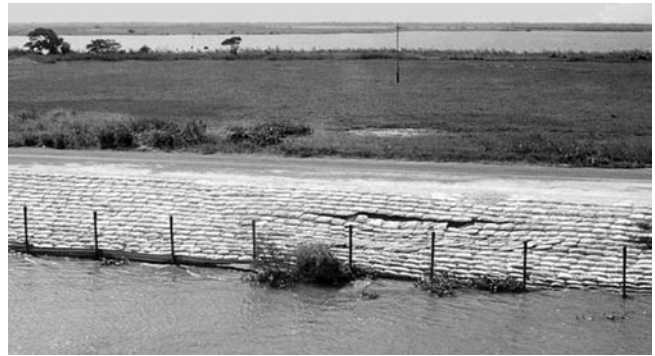
Foto 21. Falla incipiente de costalera de cemento.
