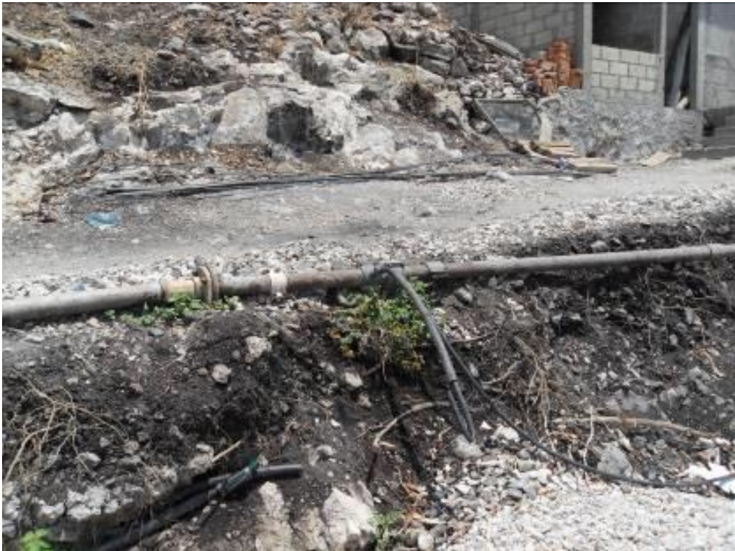
Figura 12. Tubería de agua potable y mangueras.
