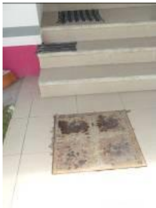
Figura 2.3. Cisterna del CDC.
