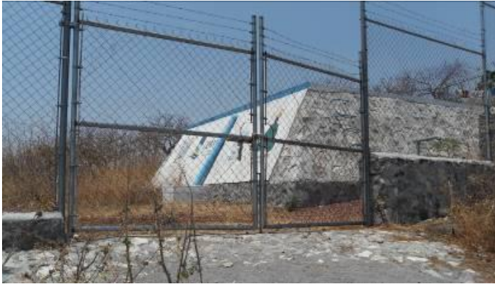
Figura 13. Nuevo tanque de agua potable.
