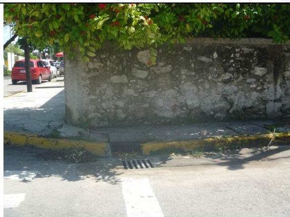
Tierra y basura amontonada que barre el usuario y la deja cerca de la rejilla de piso
