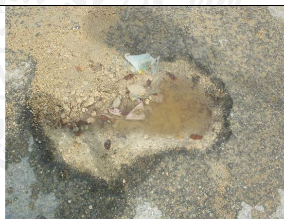
Agua en un bache no se filtra
