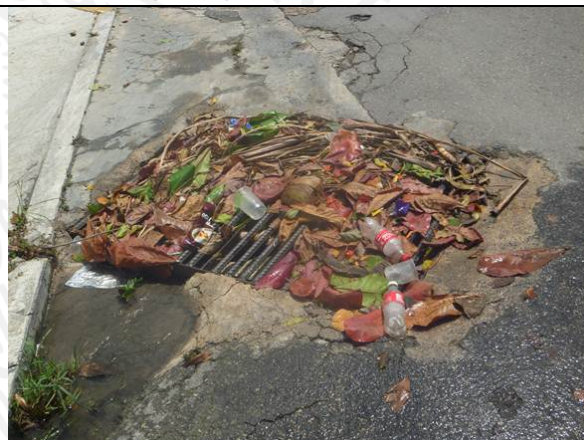
Rejilla de piso cubierta de basura acumulada por los escurrimientos de la lluvia
