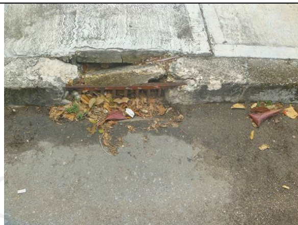
Boca de tormenta con basura de hoja, tierra acumulada y colapsada
