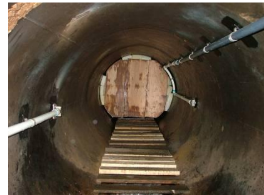
Foto 3 Instalación de ATT de un par interno en la presa Ignacio Allende (CONAGUA/IMTA, 2005)
