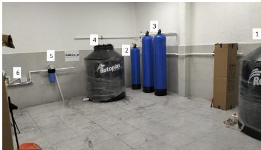
Figura 9. Ubicación de tanques y equipos
