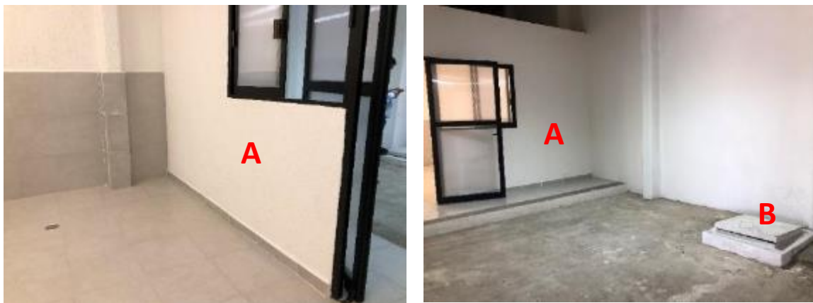
Figura 7. Falta instalación de la toma de agua en esta parte de la pared [A], la cual saldrá de la cisterna [B]
