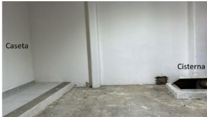
Figura 8. Ausencia de línea de agua desde la cisterna a la caseta
