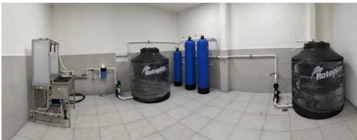
Figura 10. Sistema de tratamiento instalado
