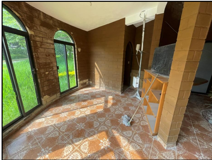
Figura 3: Muro dañado en el área de la sala.
