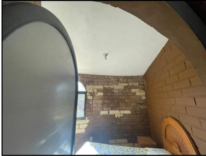
Figura 2: Muro dañado de recamara
