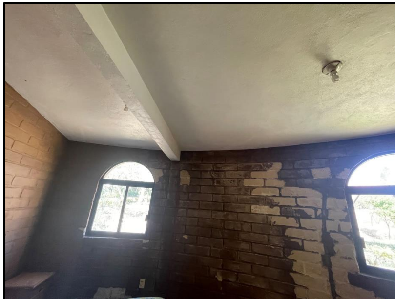
Figura 1: Muro de recamara principal, dañado
