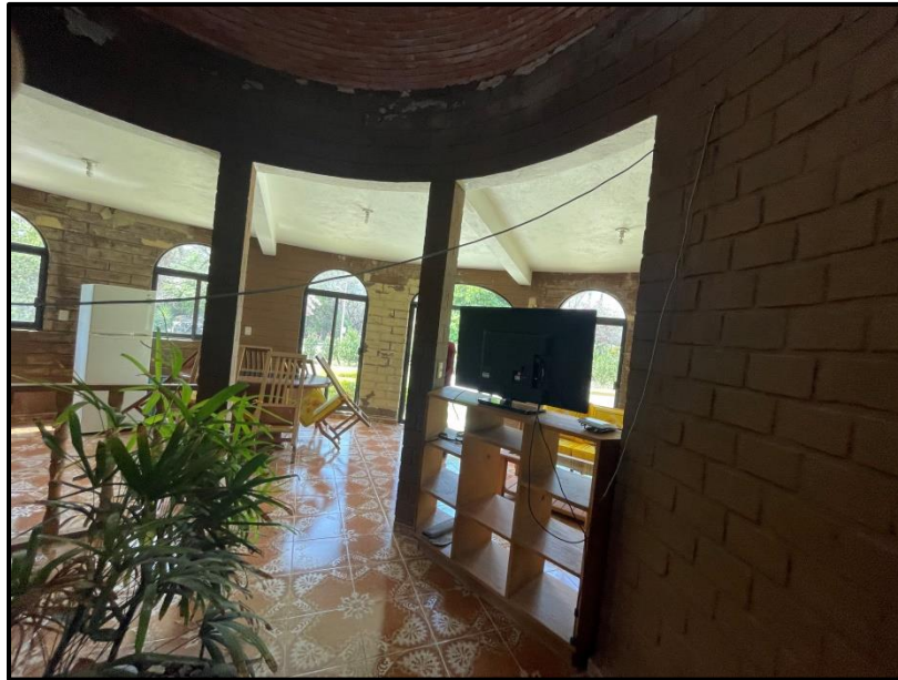
Figura 4: Vista de muros dañados de cocina y comedor.
