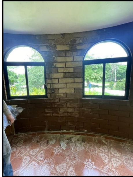
Figura 15: Muro dañado de la cocina.
