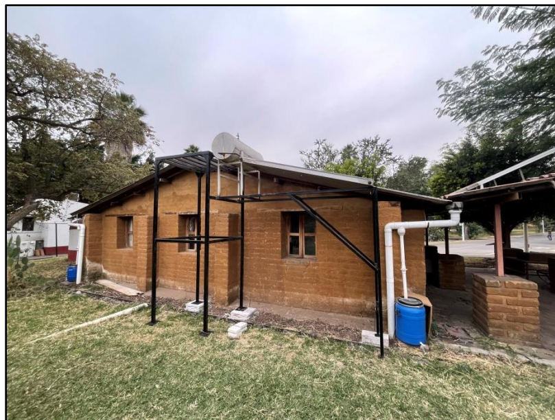
Figura 83: Instalación de calentador solar.
