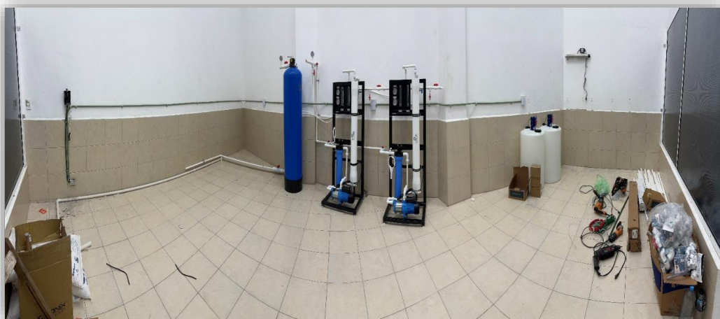
Figura 4. Equipos, accesorios y materiales adquiridos.
