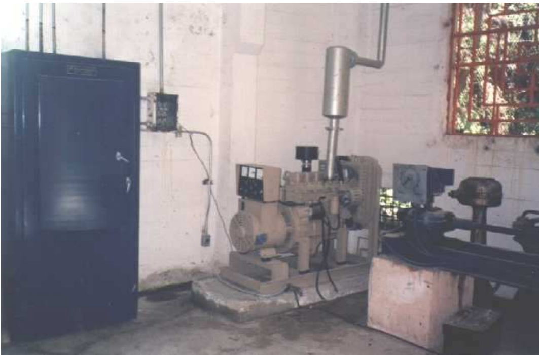
Foto 4. Interior de la casa de operación de la obra de toma, mecanismo de apertura de válvula, planta de emergencia y tablero central de control.
