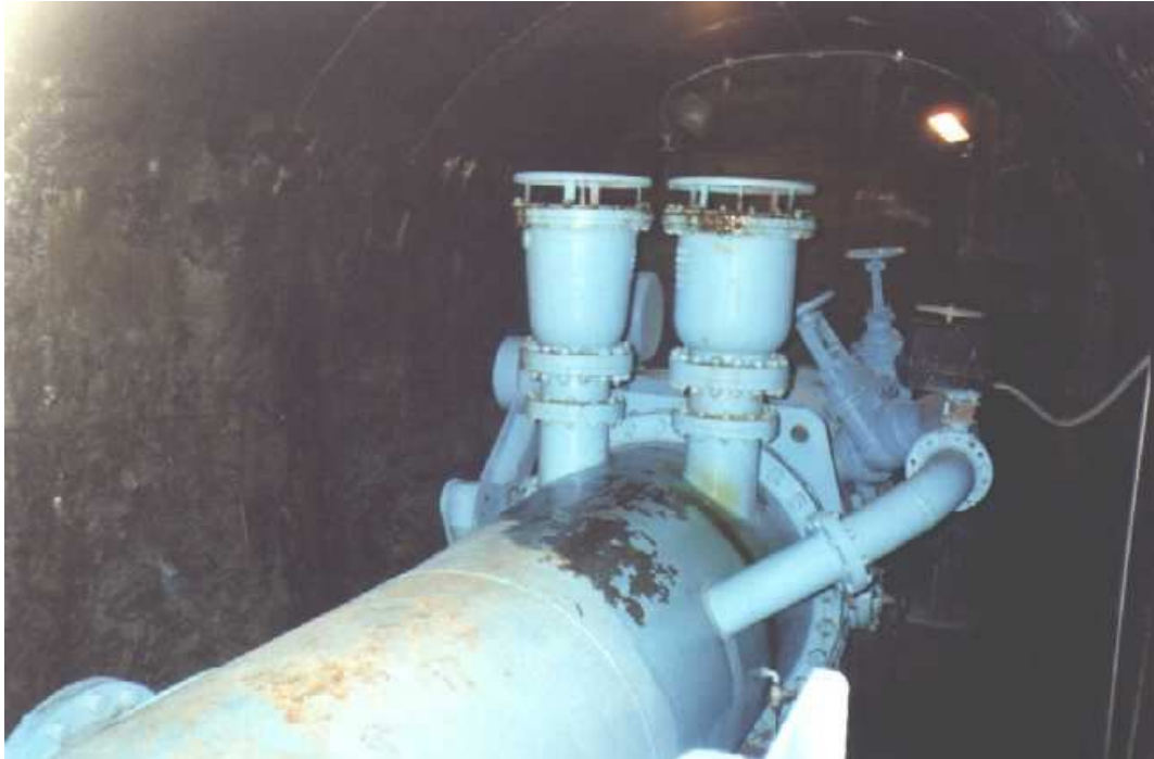
Foto 3. Válvula de mariposa (de seguridad) de 1.07m (42”) de diámetro y tapón de concreto en donde esta anclada la tubería de acero.
