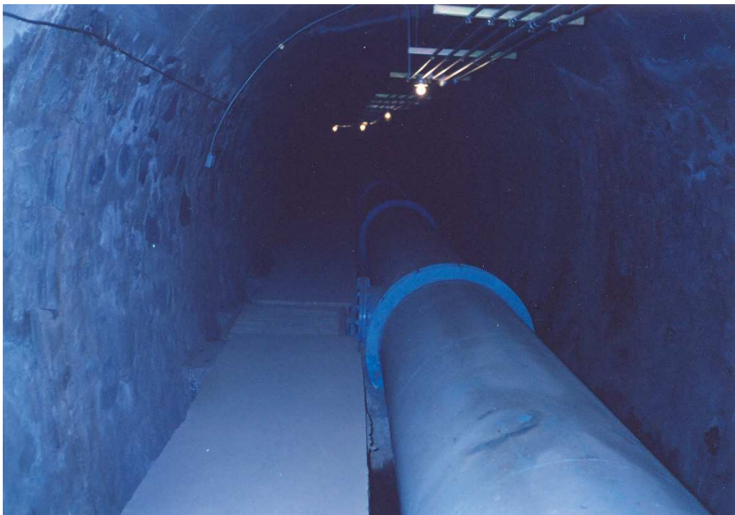
Foto 2. Tubería de fierro fundido de 1.07m (42") de diámetro, en este tramo es donde se colocarán los sensores ultrasónicos.
