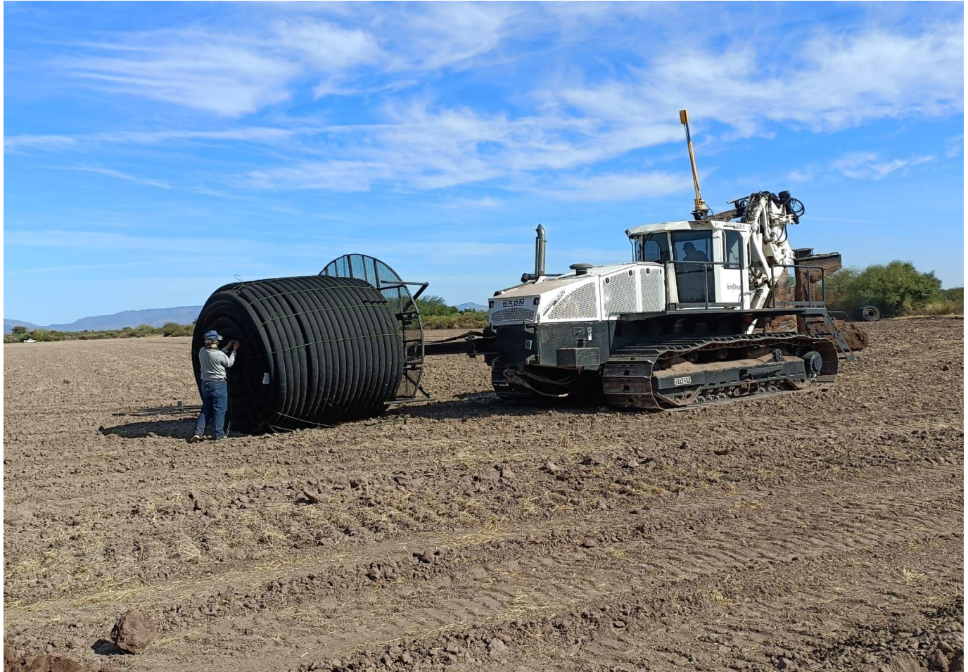
INSTALACIÓN DEL SISTEMA DE DRENAJE EN LA PARCELA DENOMINADA FIG. 5.5 DE 11.00 HA
