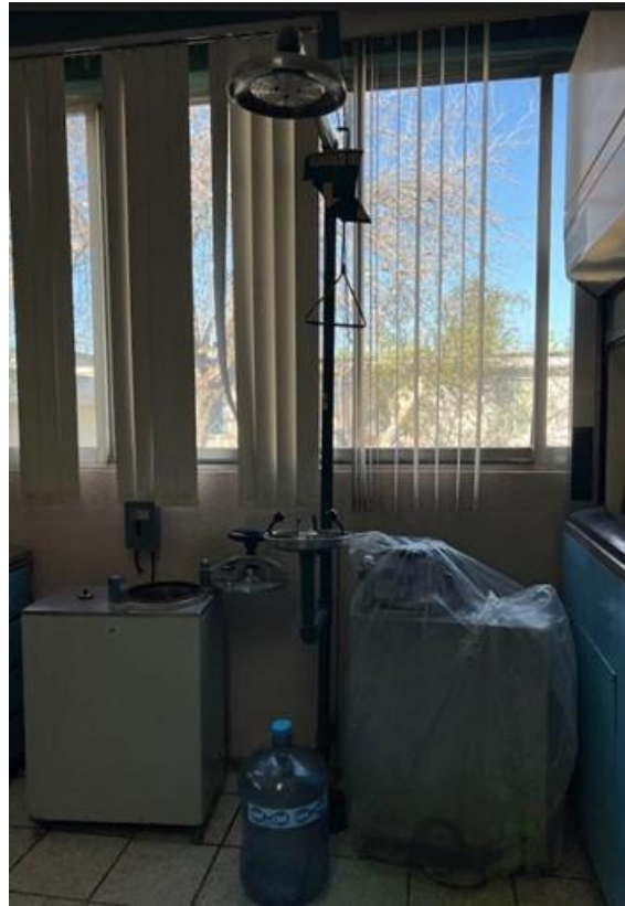
Figura 482. Regadera fuera de servicio, obstruida
