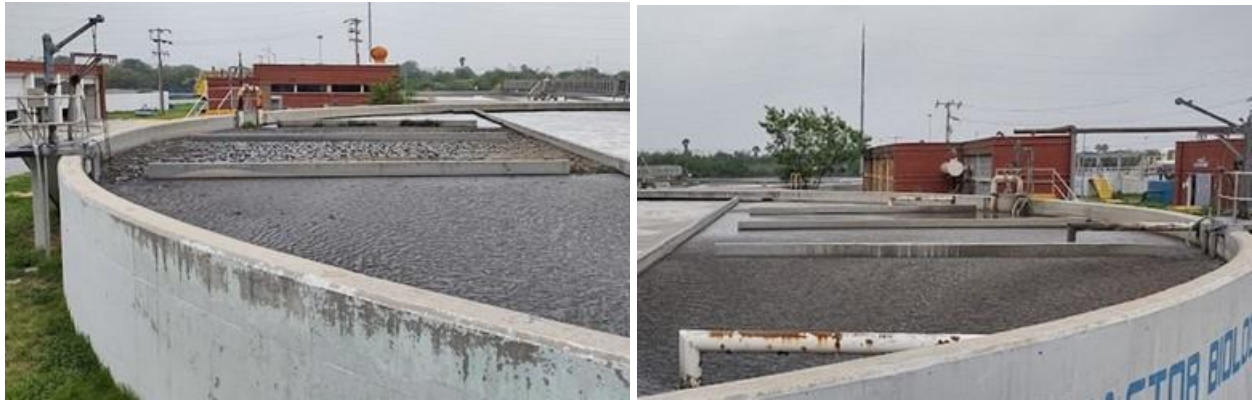
Figura 925. Tanques anóxicos sin agitación
