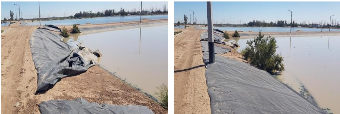
Figura 145. Levantamiento de la geomembrana y presencia de vegetación enraizada en la laguna de sedimentación B
