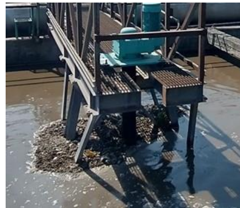
Reactor 11. Presencia de basura
