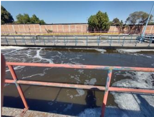
Reactor 3. Zona sin aeración
