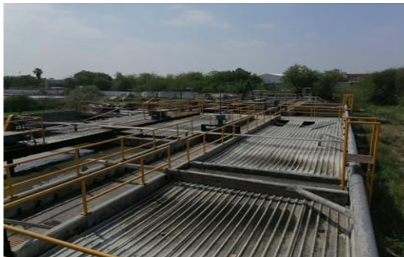
Figura 879. Estado físico de las instalaciones de la PTAR
