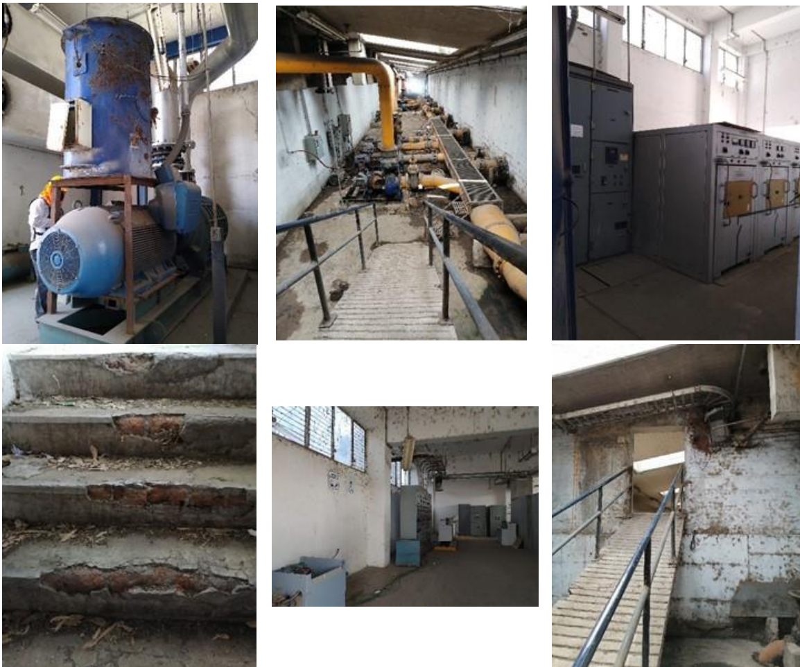
Figura 43 Estado físico de los equipos electromecánicos y la obra civil
