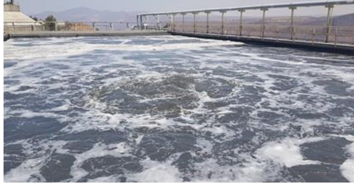
Figura 690. Rotura de difusores en los reactores de lodos activados
