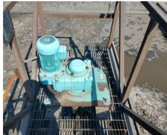
Reactor 9. Presencia de basura
