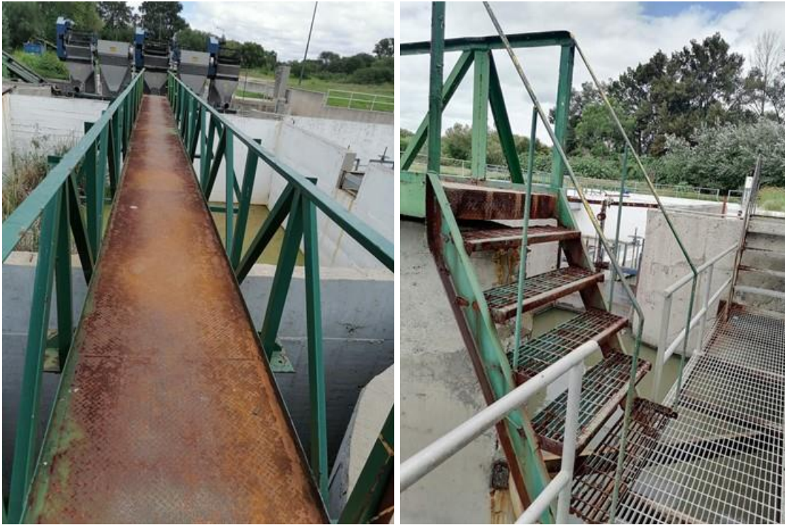
Figura 445. Corrosión en pretratamiento y tratamiento primario
