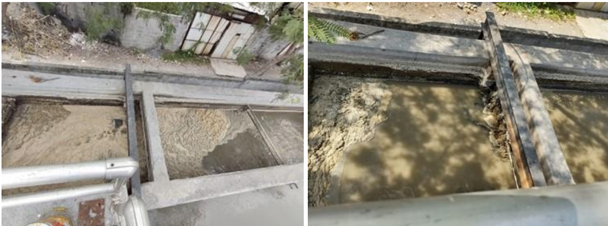
Figura 926. Presencia de grasas en canales de conducción
