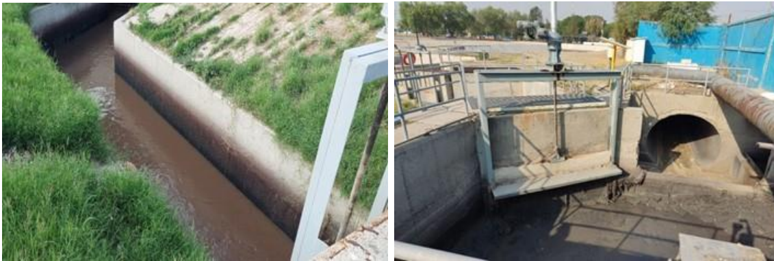
Figura 511. Caja de llegada del agua residual municipal
