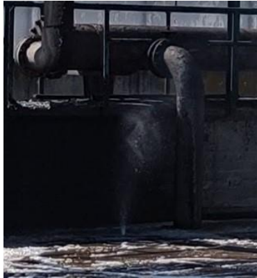
Reactor 13. Fuga de aire
