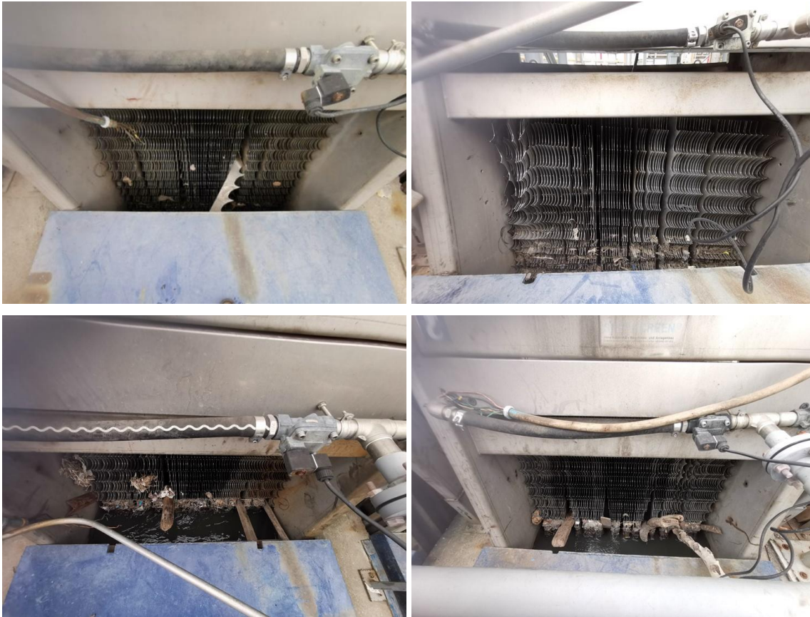
Figura 353. Rejillas finas automatizadas fuera de operación
