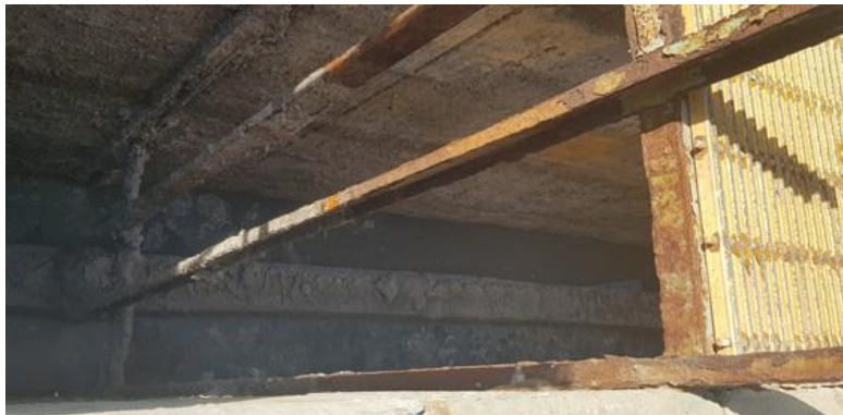
Figura 556. Estructuras metálicas en estado avanzado de oxidación
