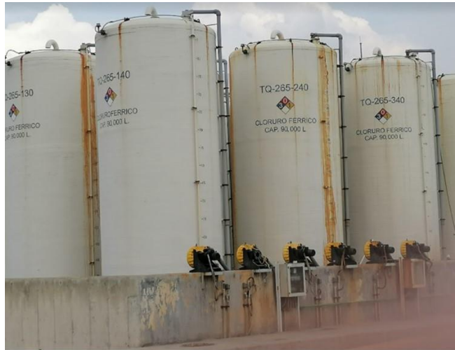
Figura 347. Tanques de almacenamiento de cloruro férrico
