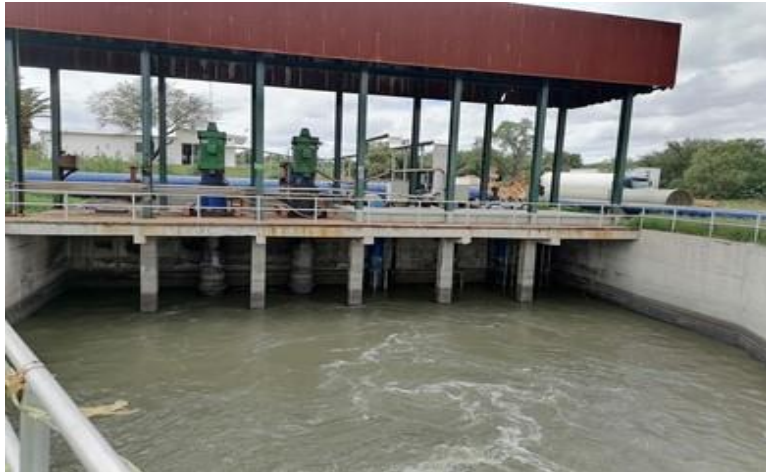
Figura 439. Cárcamo de bombeo principal
