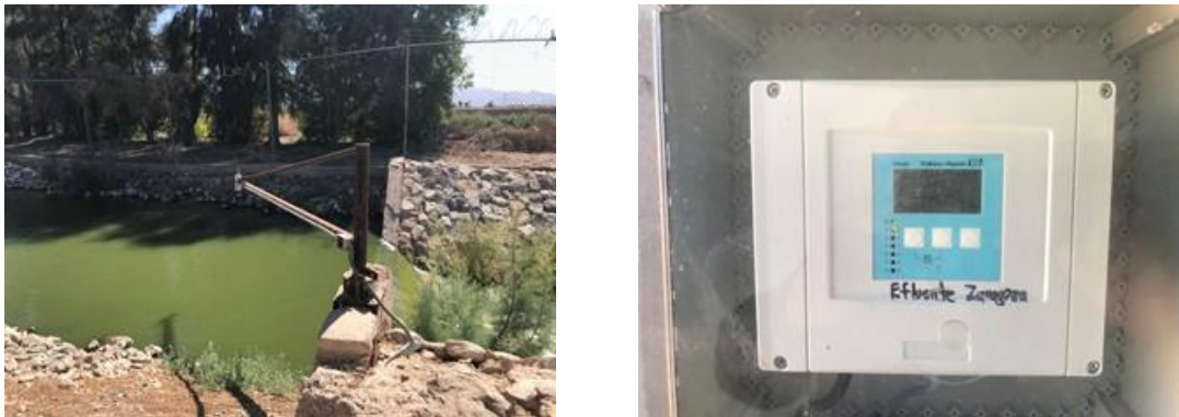
Figura 153. Medidor de flujo descarga final PTAR Zaragoza
