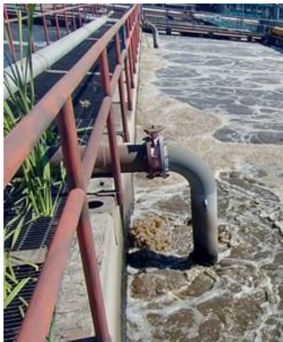
Reactor 4. Fuga de aire
