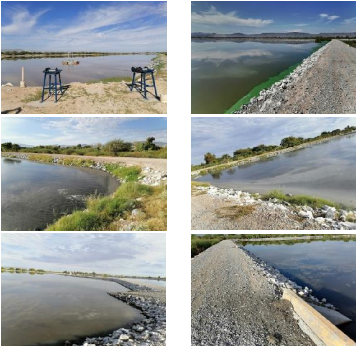
Figura 207 Estado físico de la obra civil y caminos en el sistema lagunar
