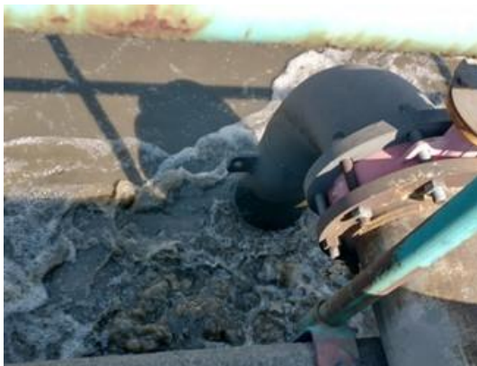
Reactor 10. Fuga de aire
