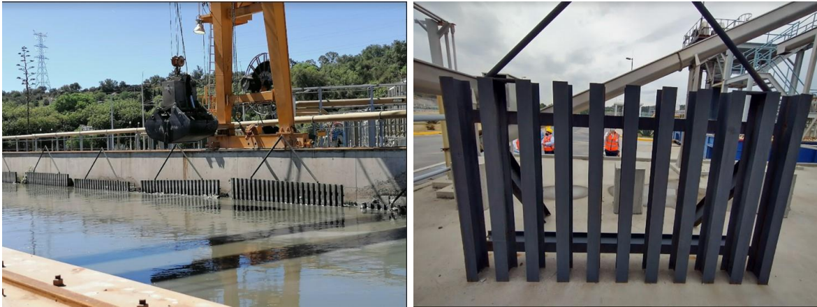
Figura 335. Canal de entrada, rejillas de desbaste y cuchara tipo almeja
