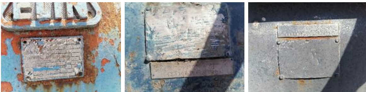
Figura 41 Etiquetas en equipos electromecánicos
