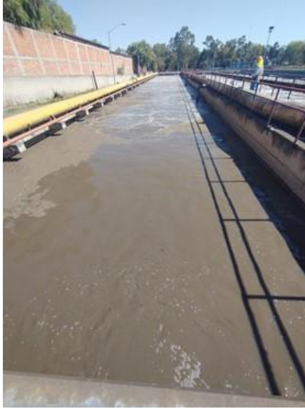
Reactor 1. Presencia de natas
