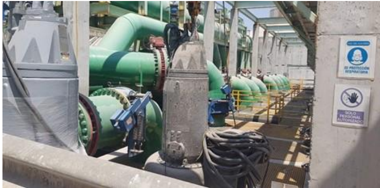
Figura 675. Sistema de bombeo de sedimentadores primarios
