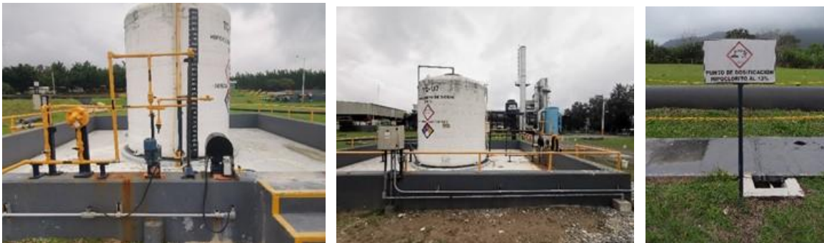
Figura 743. Tanque de hipoclorito de sodio y punto de dosificación.
