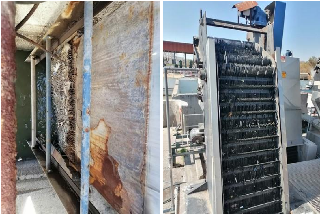
Figura 446. Falta de mantenimiento
