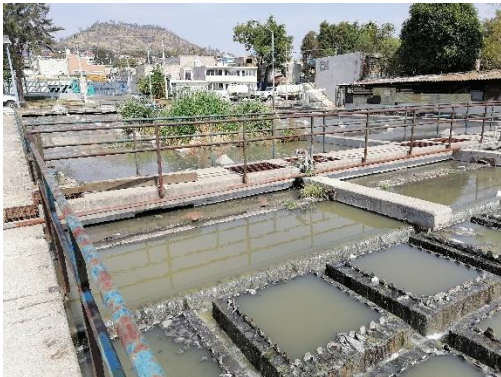
Falta mantenimiento en vertedores
