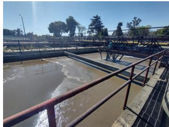
Reactor 6. Presencia de nata
