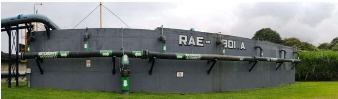
Figura 739. Reactores aerobios, RAE-301 A-B-C.
