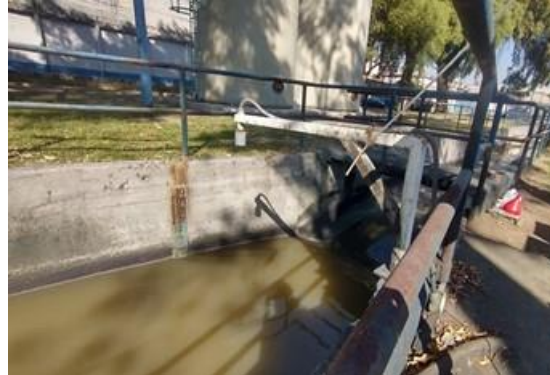
Canal Parshall Norte
