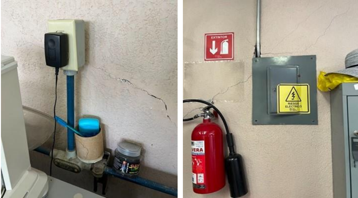
Figura 480. Pared con grietas
