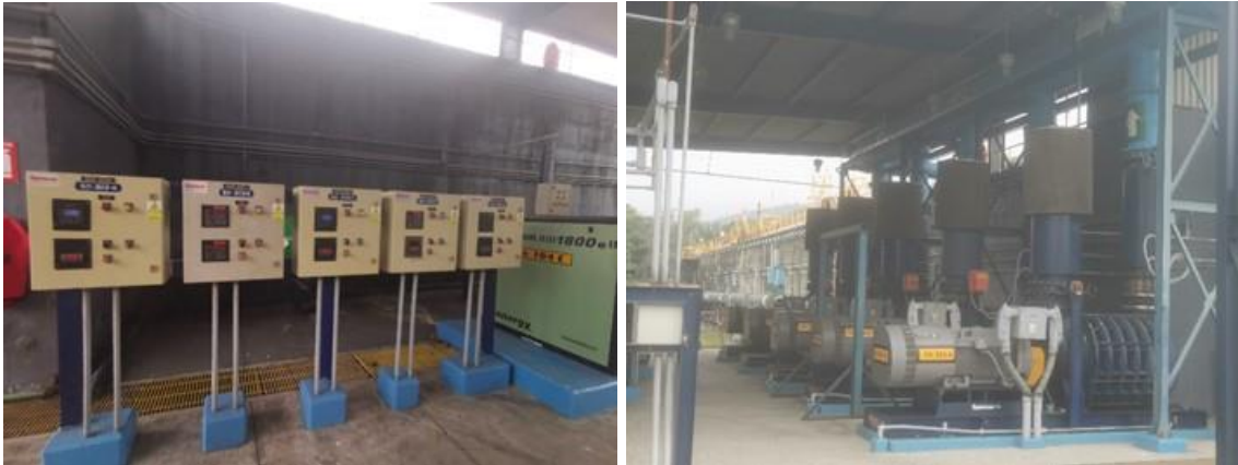
Figura 761. Vista general de los módulos secuenciales anóxico-aerobio y sopladores.
