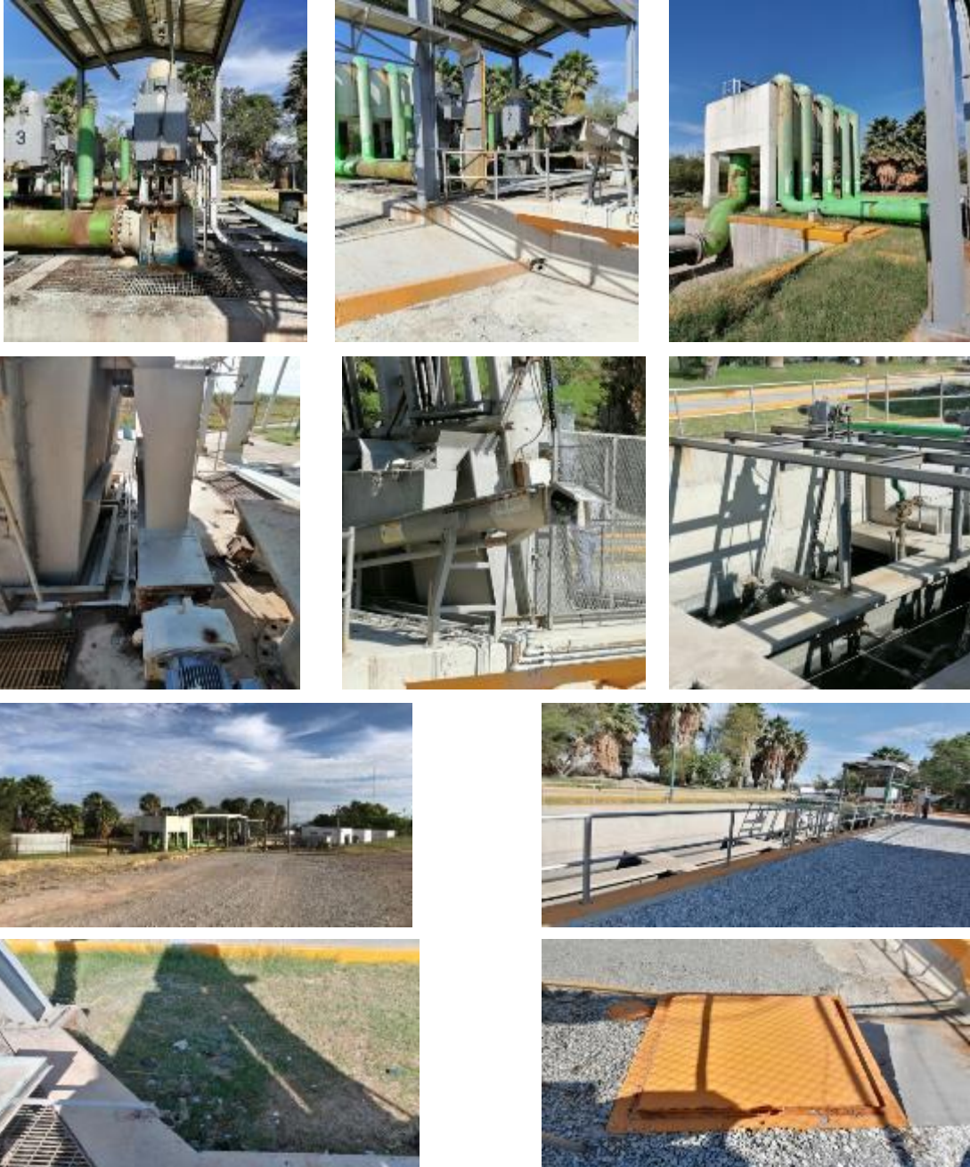
Figura 206 Estado físico del pretratamiento
