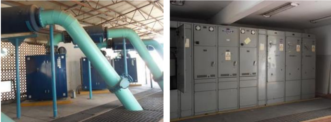
Figura 287. Sopladores para las lagunas
