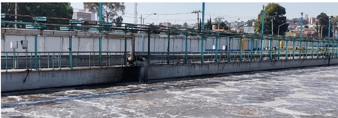
Vista general de los sensores de oxígeno disuelto Figura 33 Registro fotográfico de reactores (Parte 7)
