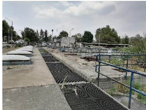
Falta de motoreductores
