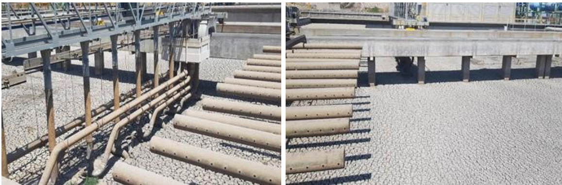
Figura 699. Sólidos y arenas acumuladas en el fondo de los sedimentadores secundarios
