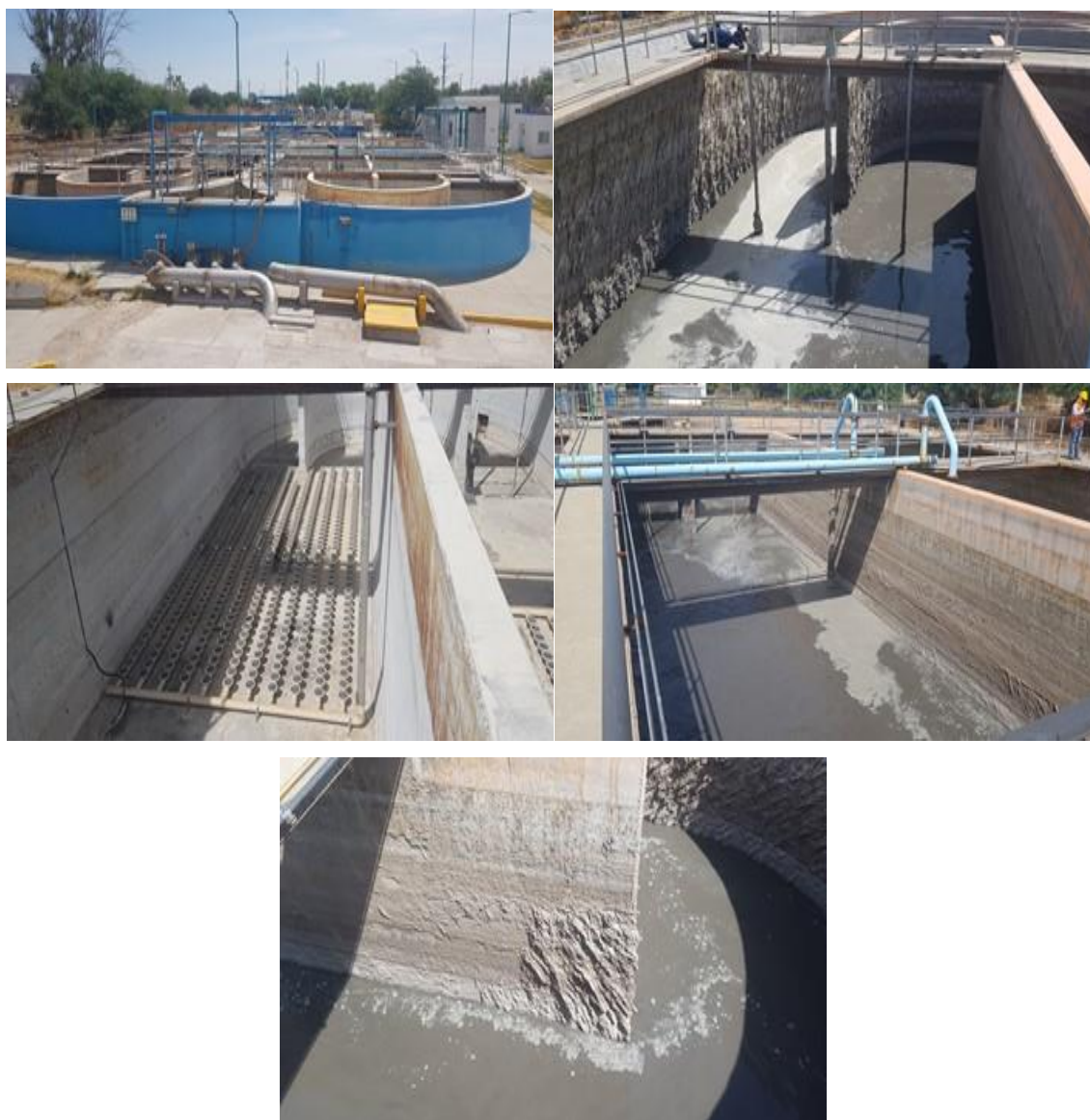
Figura 560. Tanques de homogeneización
