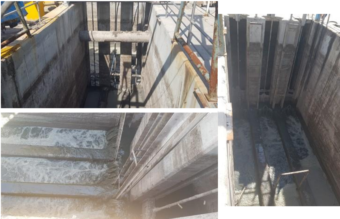
Figura 552. Canales de entrada que funcionan como pre-desbaste
