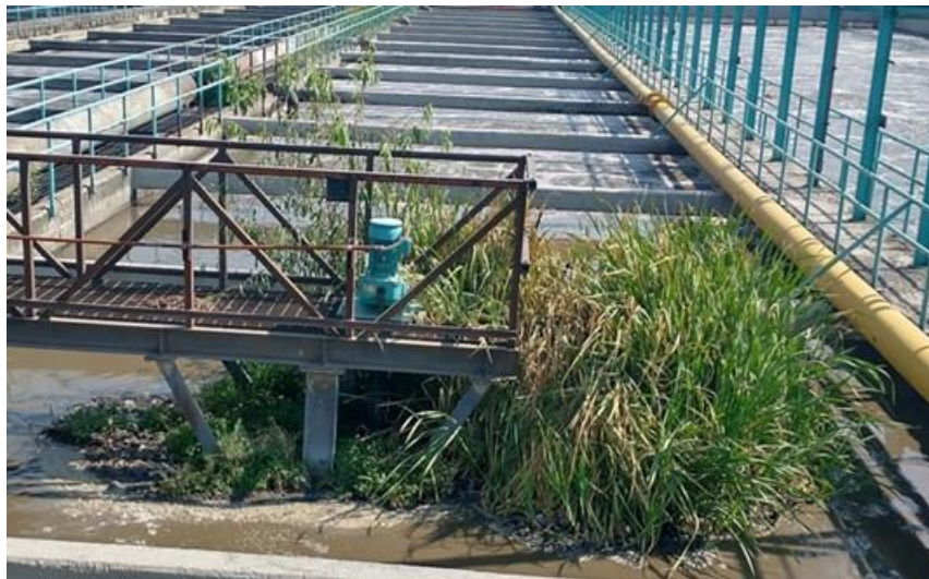
Figura 70 Mezclador del reactor 12
