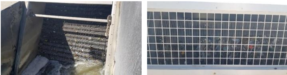
Figura 127. Retiro constante de los sólidos acumulados sobre las rejillas
