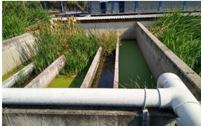
Figura 17 Filtros de arena Sur 9-12
