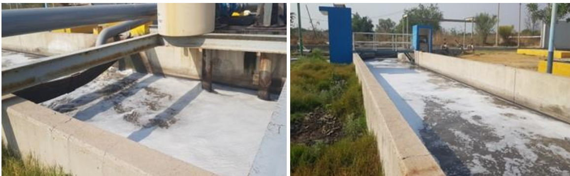
Figura 524. Efluente del tanque de contacto de cloro con la presencia de espumas derivada de la reacción química entre el cloro y la materia orgánica
