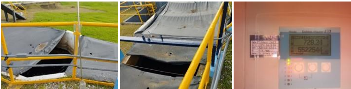
Figura 745. Canal Parshall de salida y medidor de efluente.
