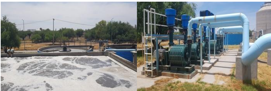
Figura 568. Segunda etapa de módulos de oxidación
