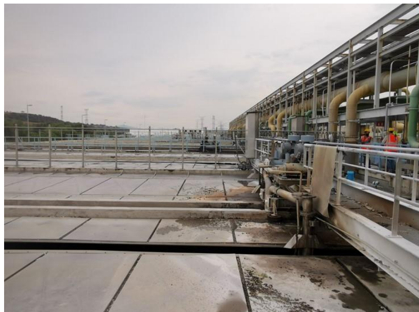
Figura 355. Desarenadores en mal estado
