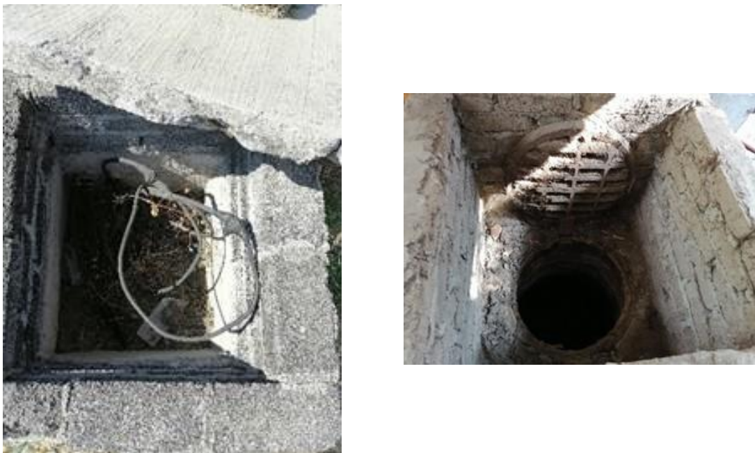
Figura 39 Falta de tapas de registros
