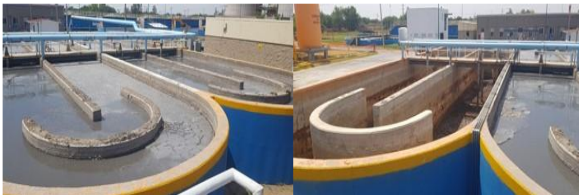
Figura 563. Tanques de homogeneización
