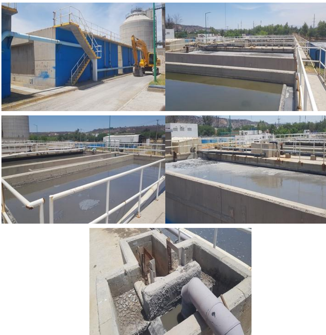
Figura 567. Primera etapa de módulos de oxidación
