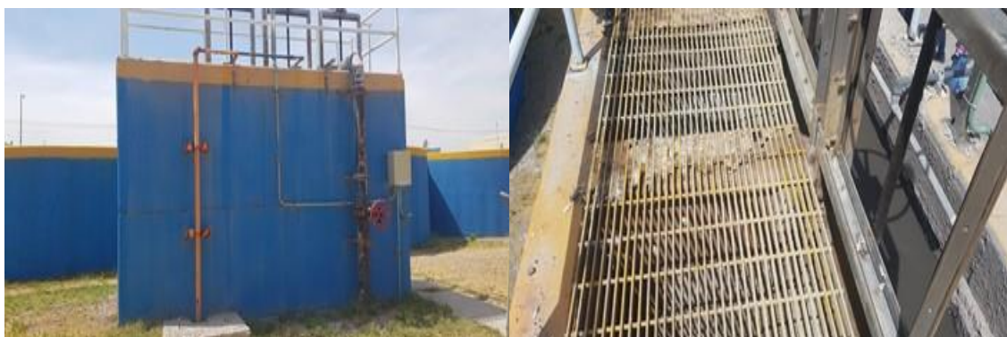
Figura 562. Caja de distribución
