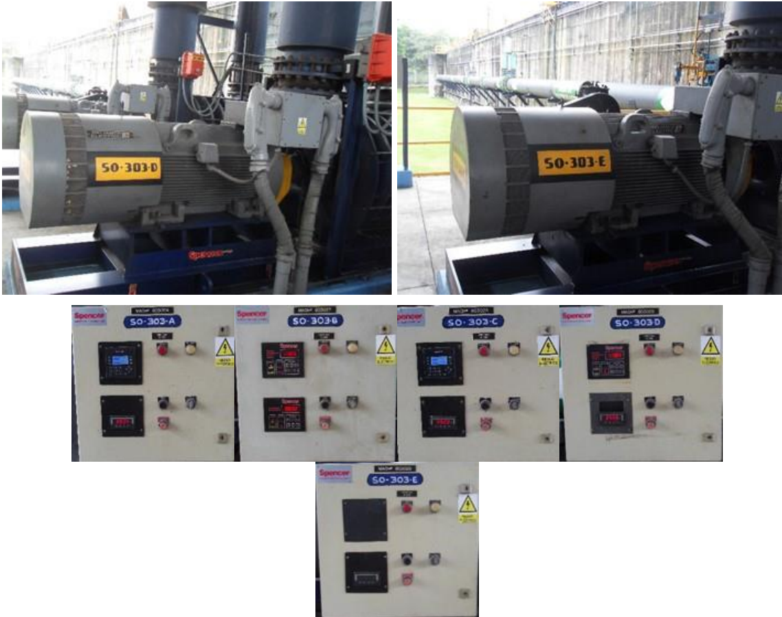
Figura 740. Sopladores SO-303 A-B-C-D-E.
