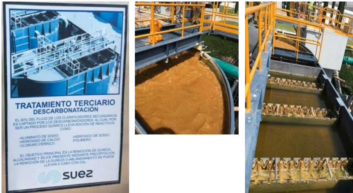
Figura 248. Descarbonación del agua residual tratada.
