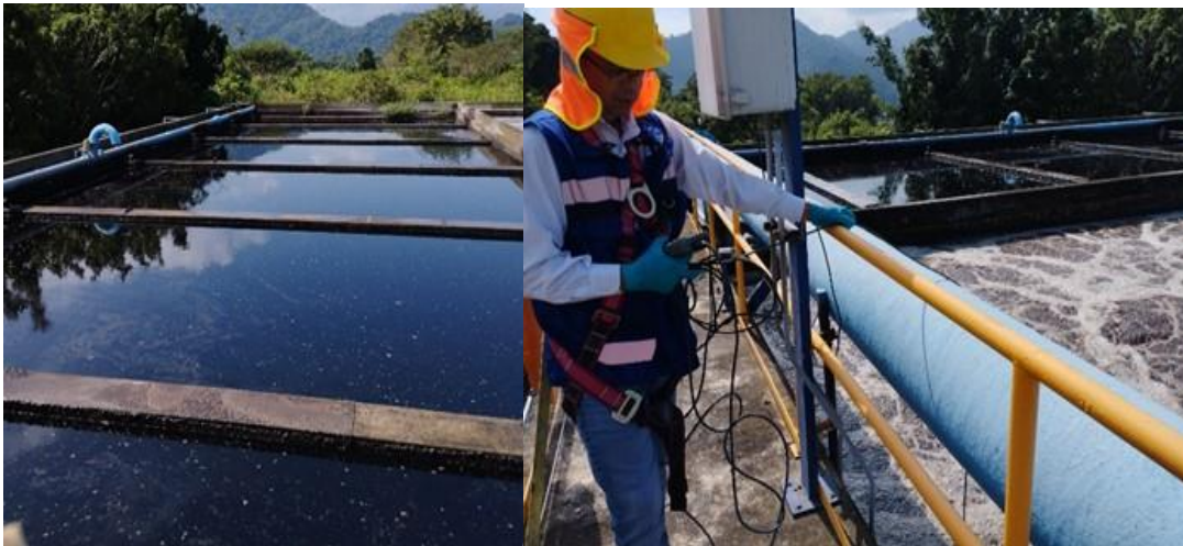
Figura 800. Tanques de aeración / sedimentación)
