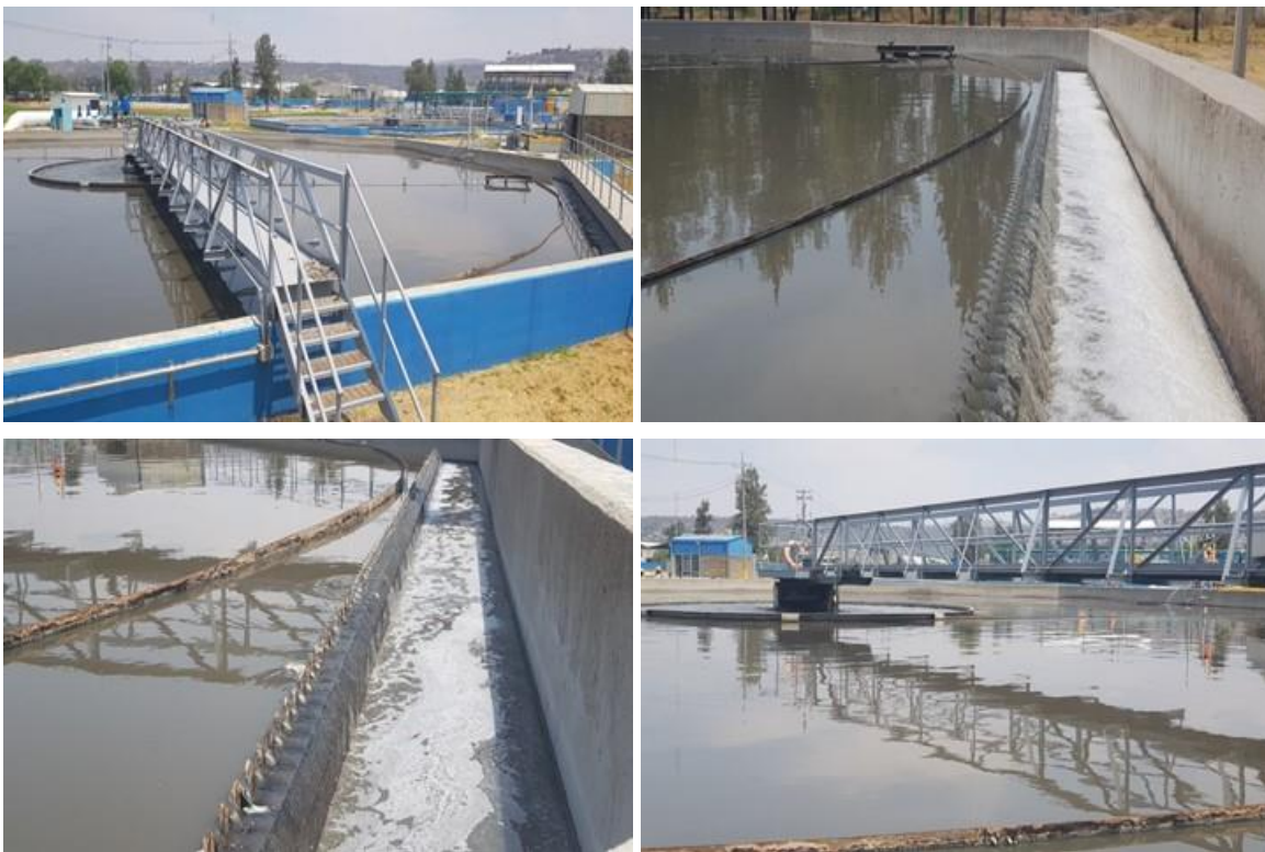
Figura 517. Sedimentador primario que trata las aguas residuales provenientes del efluente final del módulo de Desbaste
