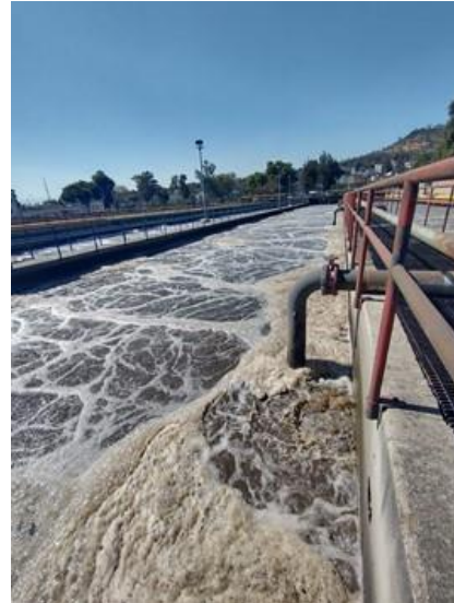
Reactor 2. Fuga de aire
