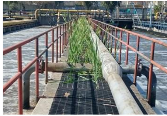
Entre Reactor 4 y 3. Presencia de vegetación
