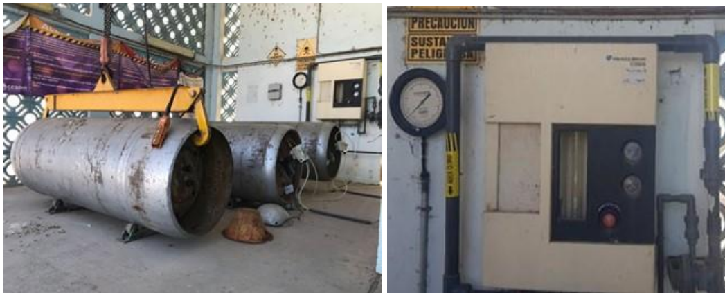
Figura 152. Caseta de desinfección con cloro gas
