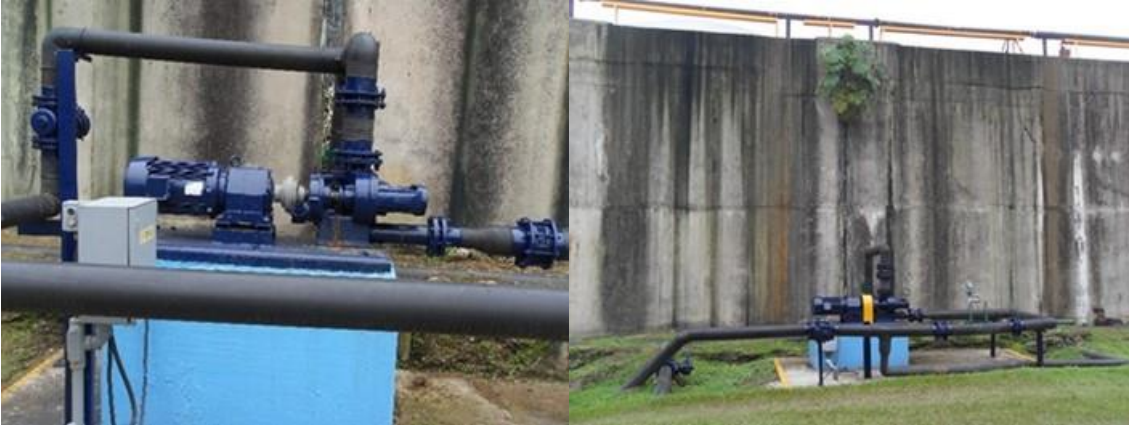
Figura 794. Bombas para purga de lodos de RAN's (BP-206)
