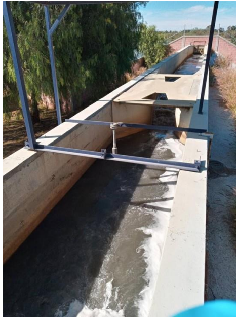
Figura 245. Canal con el efluente del tratamiento primario avanzado.
