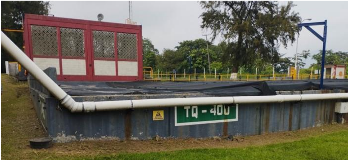
Figura 762. Tanque de contacto de cloro TQ-400
