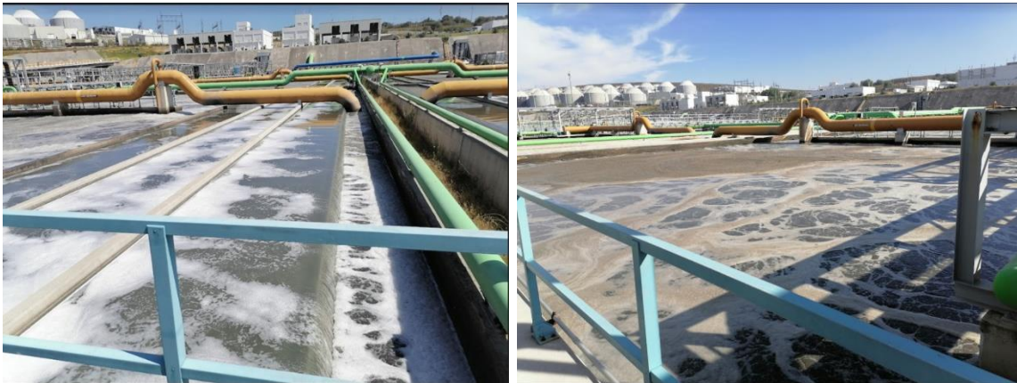
Figura 343. Reactor biológico - proceso de lodos activados
