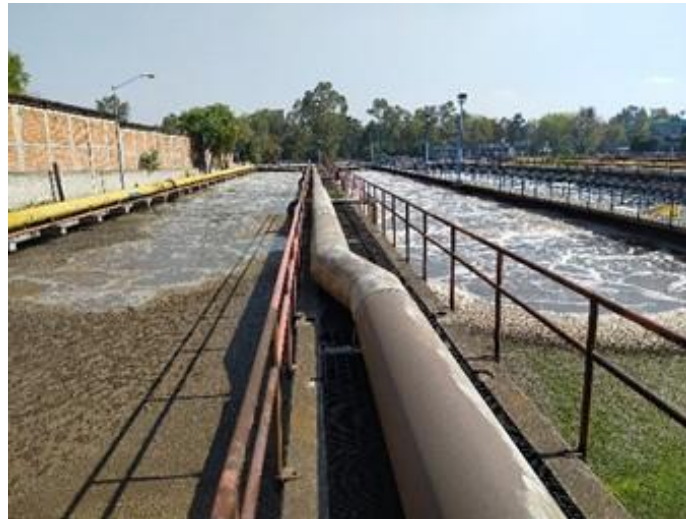
Figura 9. Reactores aerobios de lodos activados
