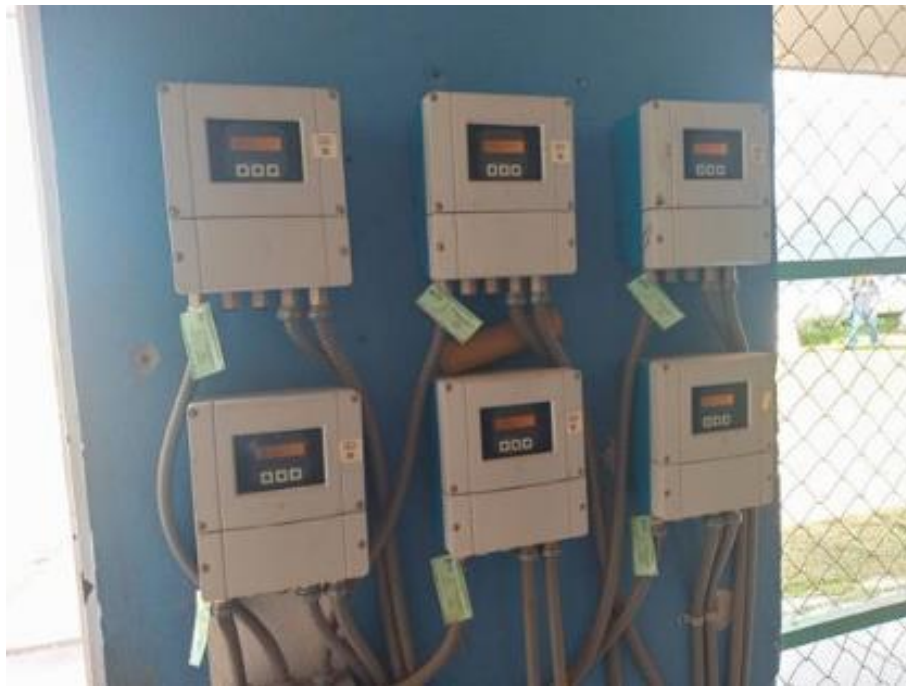
Figura 299. Medidores de caudal de las seis bombas que alimentan a las lagunas aireadas
