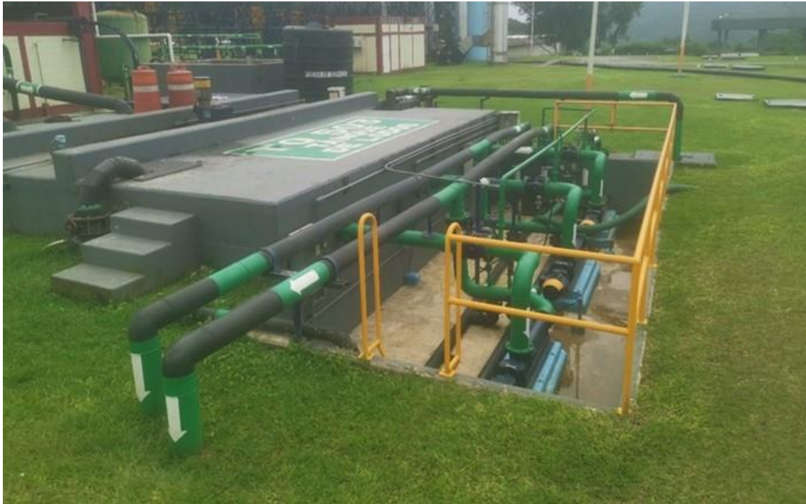
Figura 788. Tanque de mezcla de lodos TQ-503
