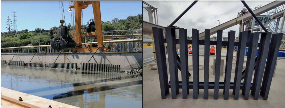
Figura 350. Canal de entrada, rejillas de desbaste y cuchara tipo almeja.
