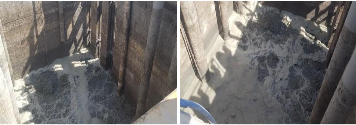
Figura 554. Cárcamo de bombeo en funcionamiento
