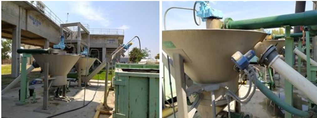
Figura 620. Clasificador de arenas fuera de operación.
