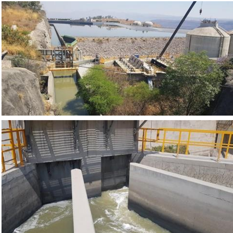
Figura 670. Canal de la CFE y caja de distribución hacia el sistema de pretratamiento
