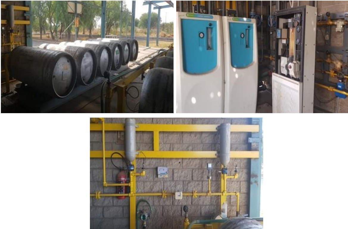
Figura 525. Caseta de cloración
