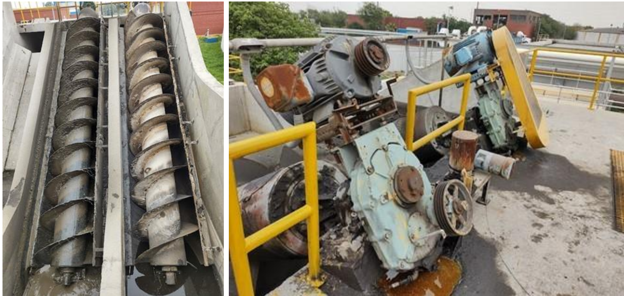
Figura 928. Bomba de recirculación de lodos fuera de operación
