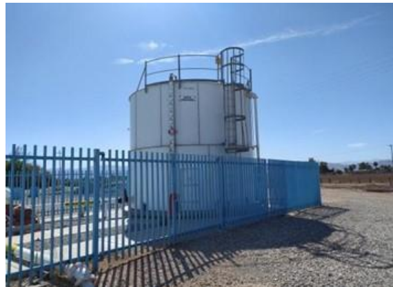
Figura 120. Tanque de almacenamiento de agua tratada
