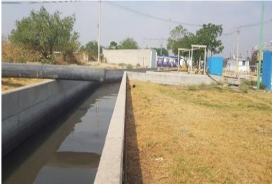
Figura 507. Canal a cielo abierto que conduce el excedente del agua residual
