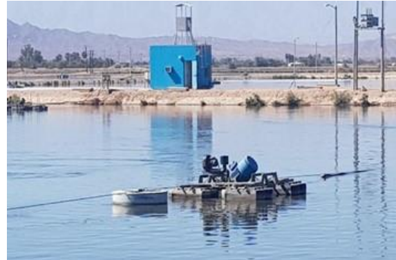
Figura 113. Sistema de aireación
