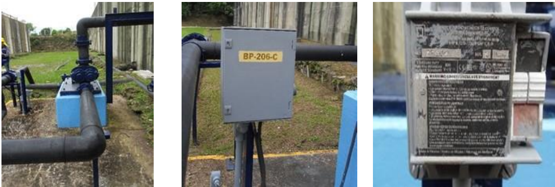
Figura 737. Bombas de extracción de lodos de reactores anaerobios (BP-206 A-B-C).
