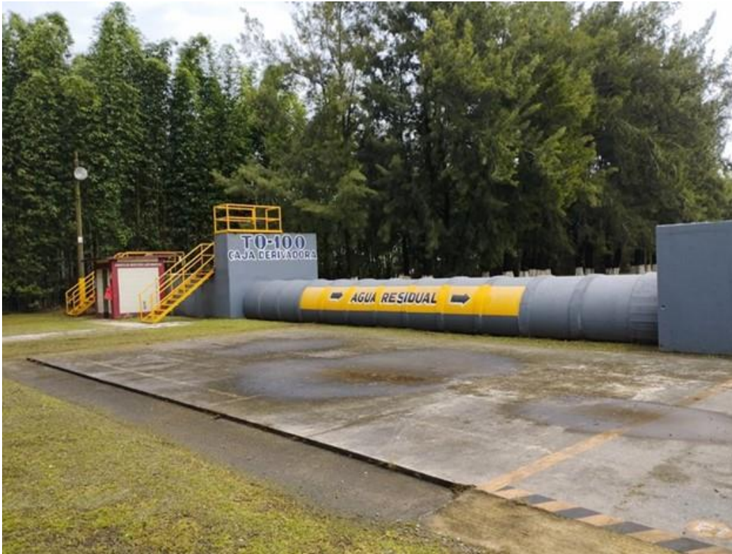
Figura 782. Influyente a PTAR: Caja Derivadora y colector de entrada.
