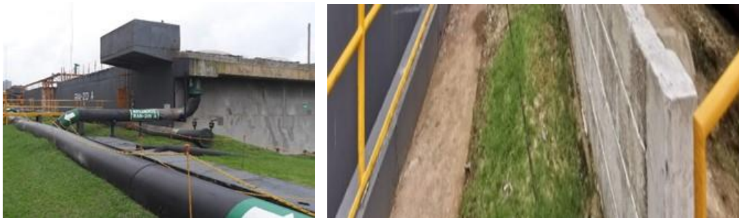
Figura 736. Efluente de reactores anaerobios (RAN-201 A).
