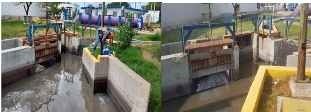
Figura 510. Descarga final de la PTAR Municipal
