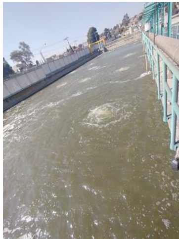
Reactor 14. Difusores dañados
