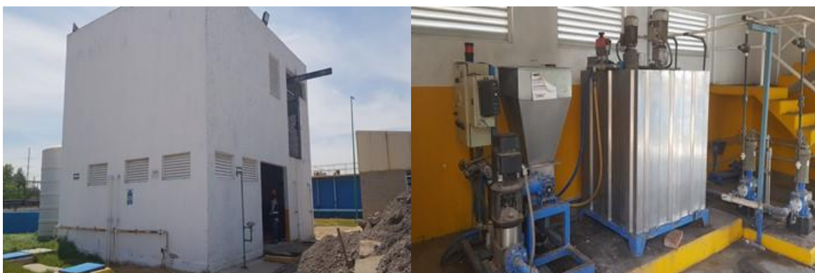
Figura 565. Caseta para la preparación de los agentes químicos para llevar a cabo el proceso de coagulación-floculación
