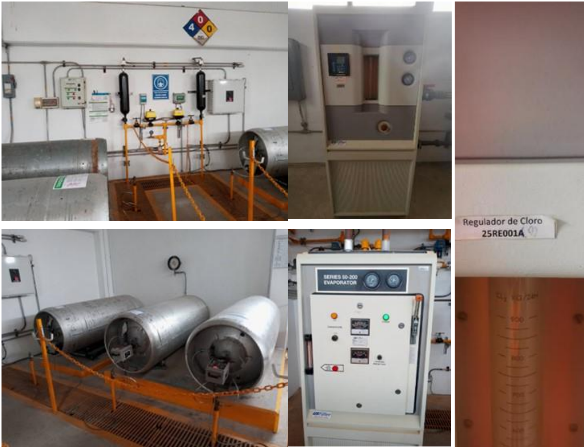
Figura 249. Aspectos de la zona de cloración en la PTAR.
