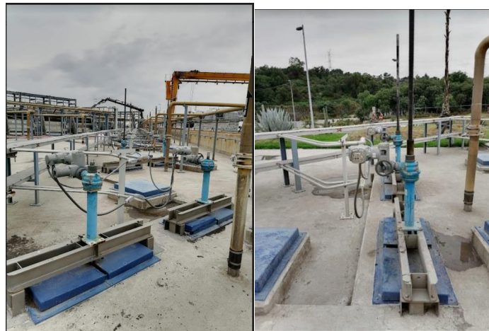
Figura 351. Compuertas de entrada de los canales
