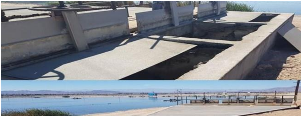
Figura 124. Caja derivadora que distribuye el agua residual al sistema lagunar
