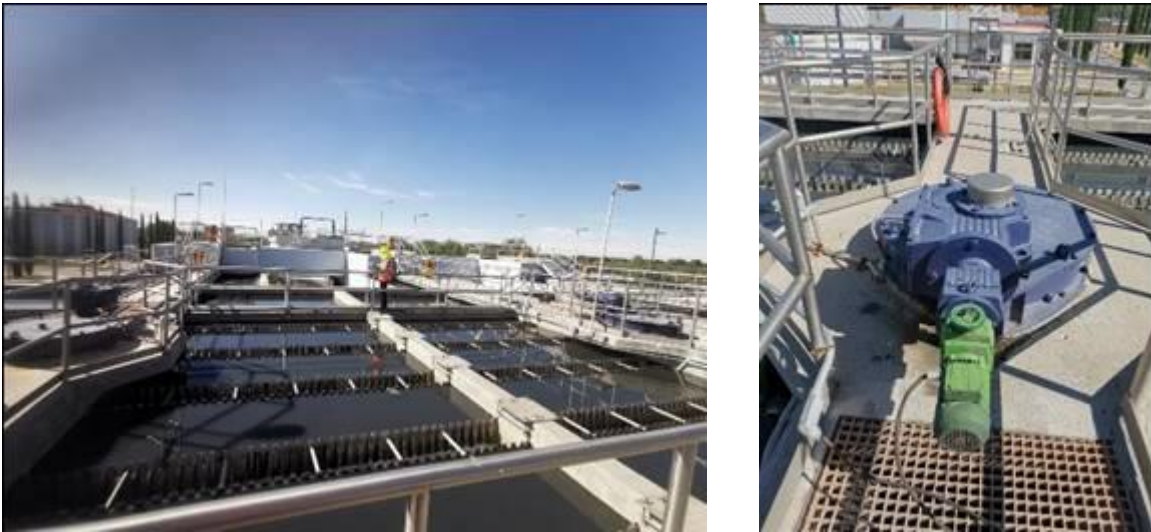
Figura 243. Vistas de los “Densadeg” y las canaletas de recolección.
