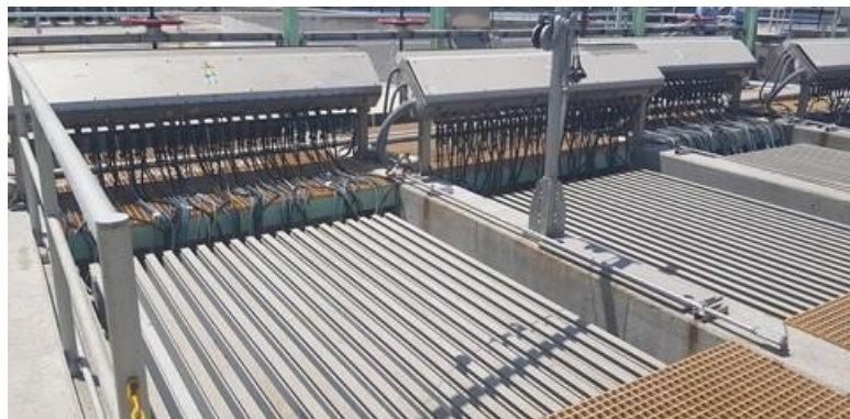
Figura 612. Sistema de desinfección con luz ultravioleta
