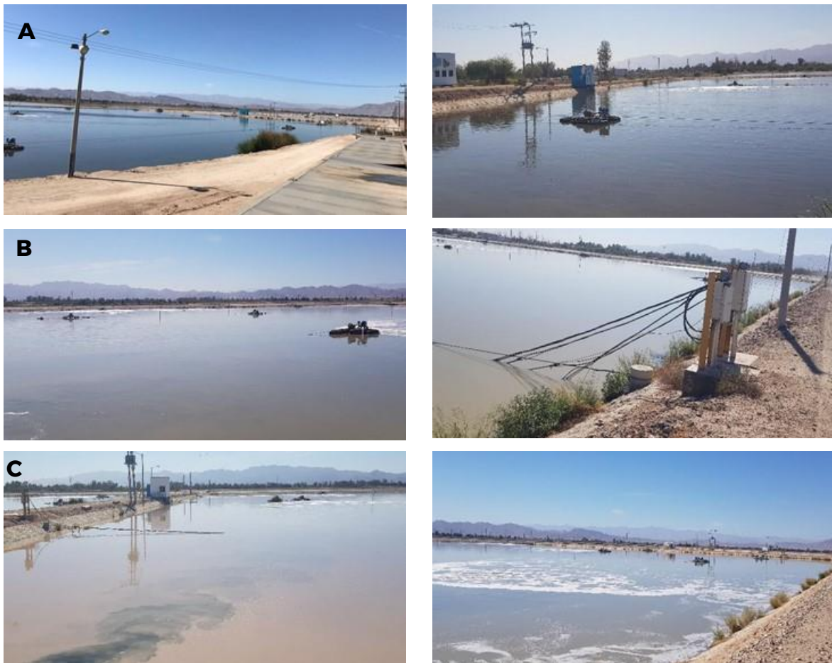
Figura 132. Lagunas aireadas de la PTAR de Zaragoza
