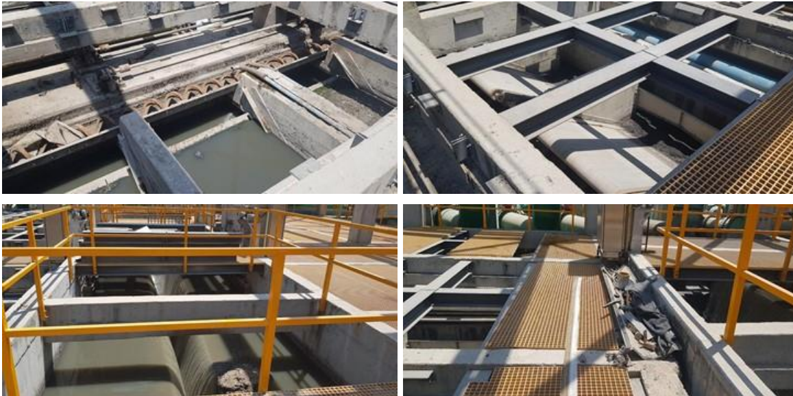
Figura 686. Unidad de tratamiento primario conformado por bandas filtrantes
