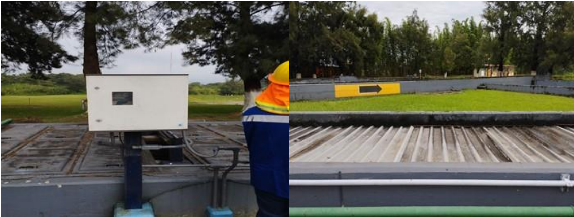
Figura 785. Canales de interconexión y medidor de flujo
