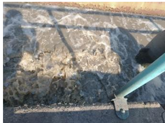
Reactor 11. Fuga de aire
