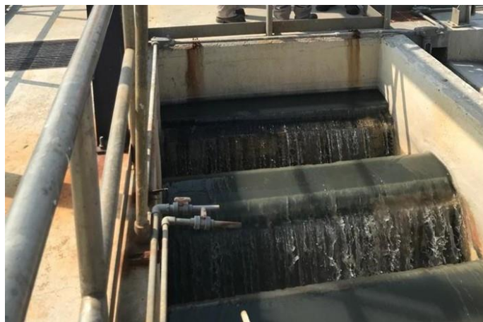
Figura 242. Punto de aplicación de cloruro férrico y polímero para el primario avanzado.
