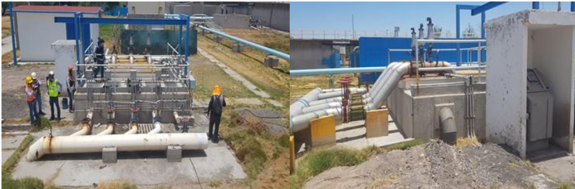
Figura 570. Cárcamo de bombeo del efluente de la PTAR Desbaste
