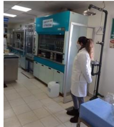
Campana de extracción
