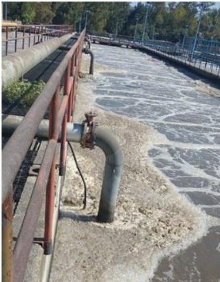
Reactor 2, Fuga de aire
