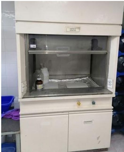
Campana de extracción
