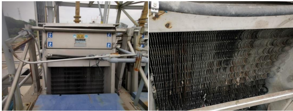
Figura 338. Rejillas finas automatizadas
