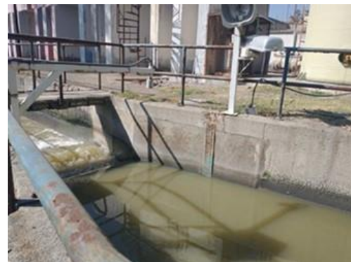
Canal Parshall Sur
