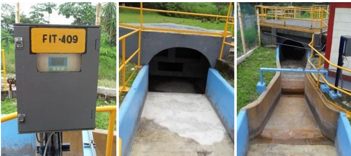
Figura 726. Vertedor de demasías.
