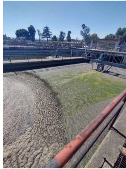
Reactor 2. Presencia de nata espesa
