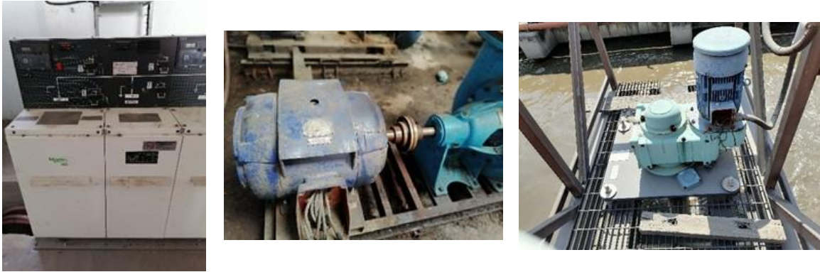
Figura 42 Equipos electromecánicos en funcionamiento
