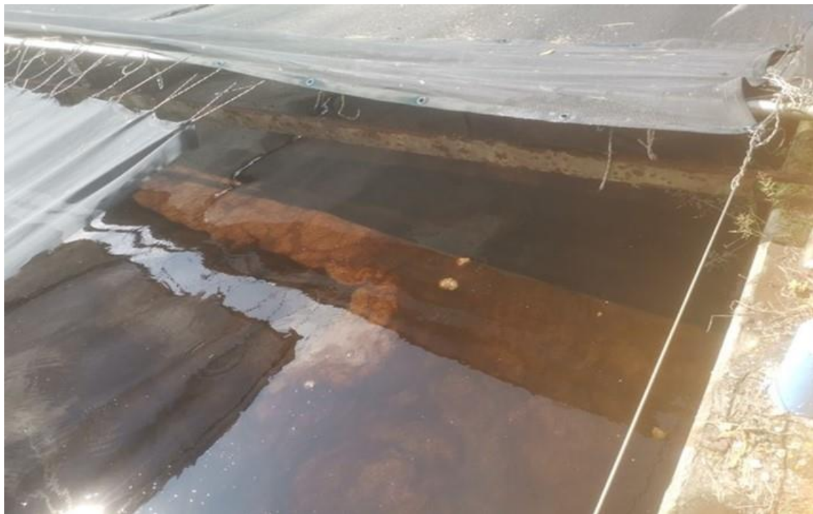
Figura 809. Tanque de contacto: arrastre de sólidos.
