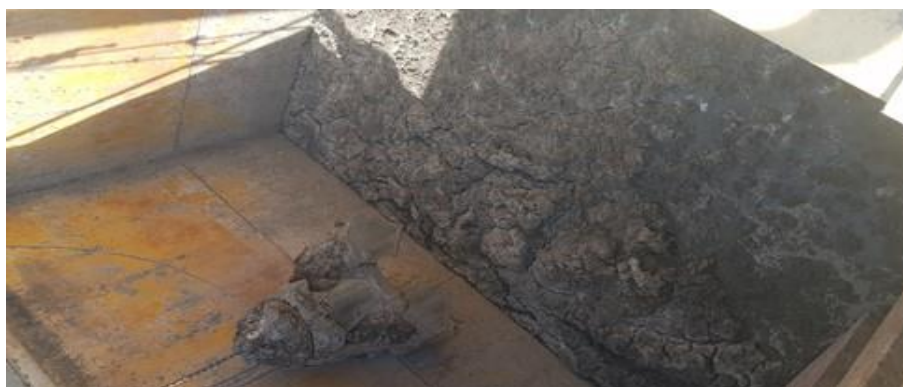
Figura 553. Canales y cárcamo de bombeo fuera de operación
