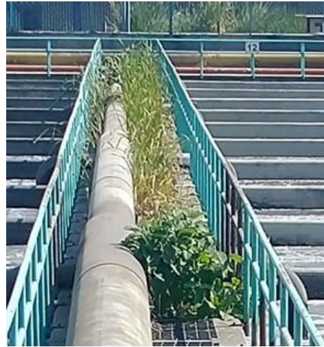
Entre Reactor 11 y 12. Presencia de vegetación
