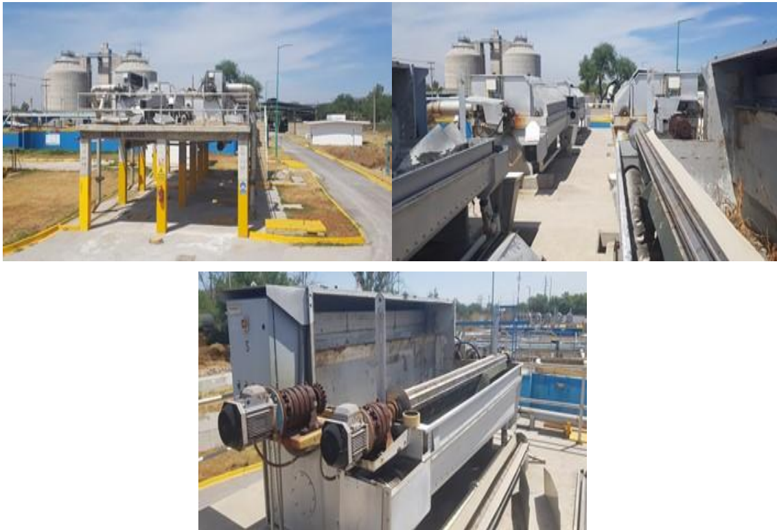
Figura 561. Área de tamizadores las cuales están fuera de servicio
