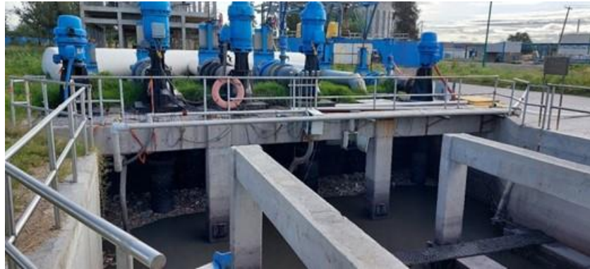
Figura 514. Cárcamo de bombeo
