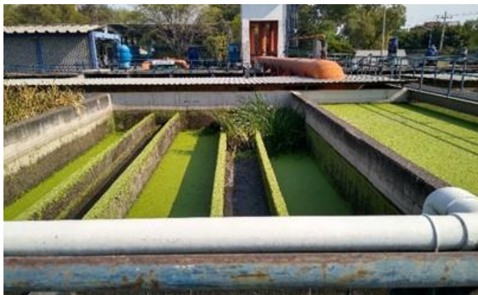
Figura 21 Filtros de arena Sur 13 y 14
