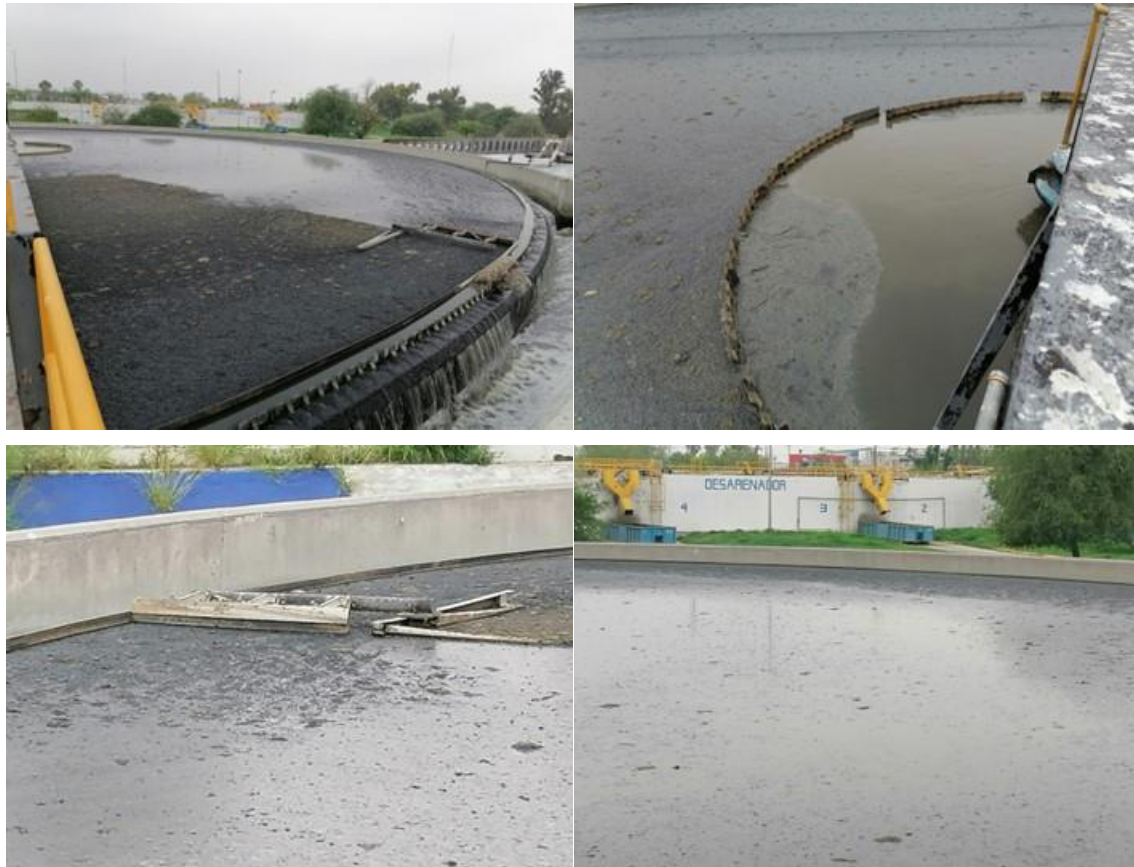
Figura 874. Estado del sedimentador primario 1 y 4
