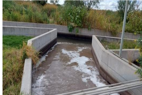
Figura 508. Efluente del tanque de contacto de cloro
