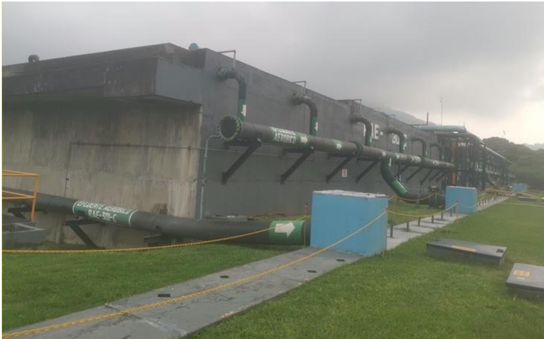
Figura 796. Vista de los reactores aerobios
