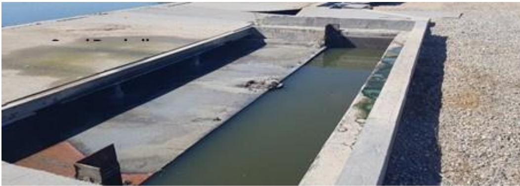
Figura 123. Descarga de agua residual emisor PBAR 8 hacia el canal Parshall
