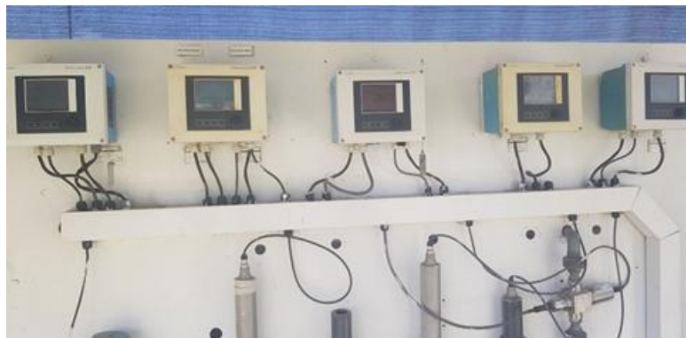
Figura 633. Sensores colocados en la descarga final de la PTAR El Ahogado
