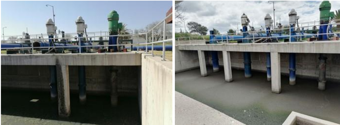
Figura 437. Cárcamo de bombeo primario
