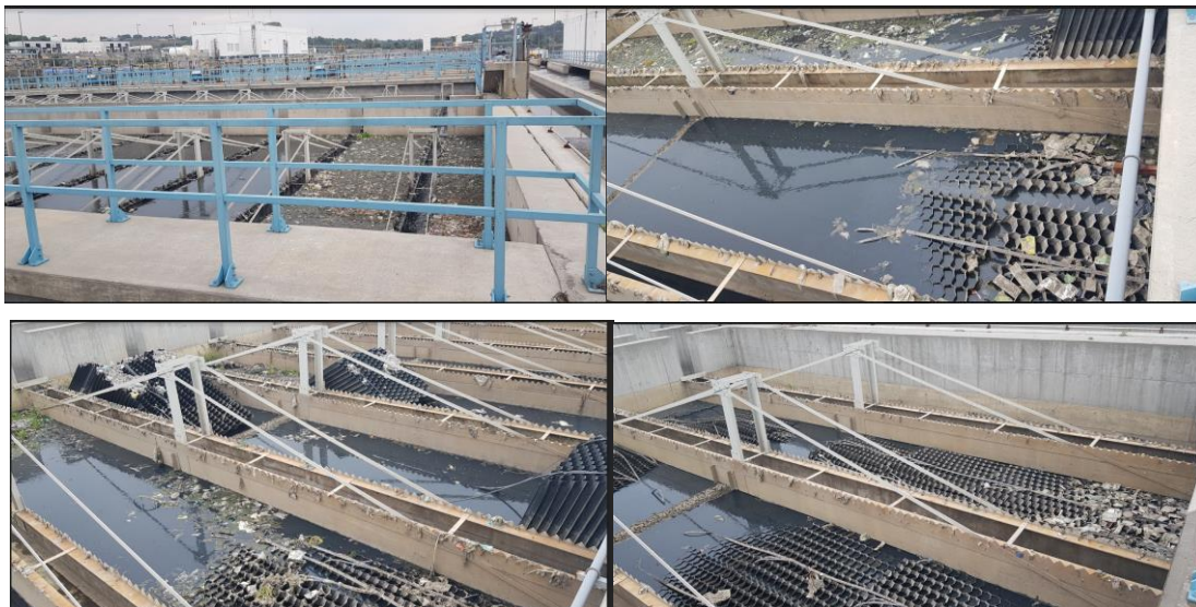
Figura 357. Módulo de placas inclinadas
