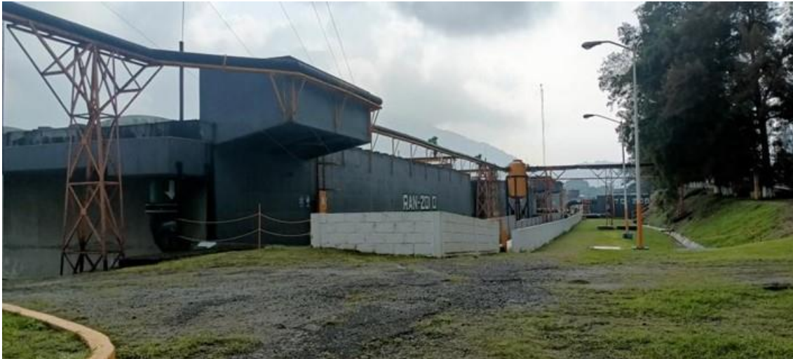
Figura 759. Vista del Reactor Anaerobio de Flujo Ascendente “D” en la zona del efluente.
