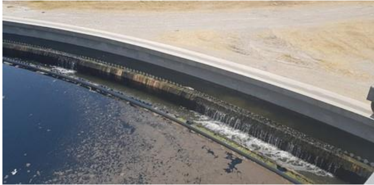
Figura 630. Desnivelación y falta de vertederos en los sedimentadores secundarios
