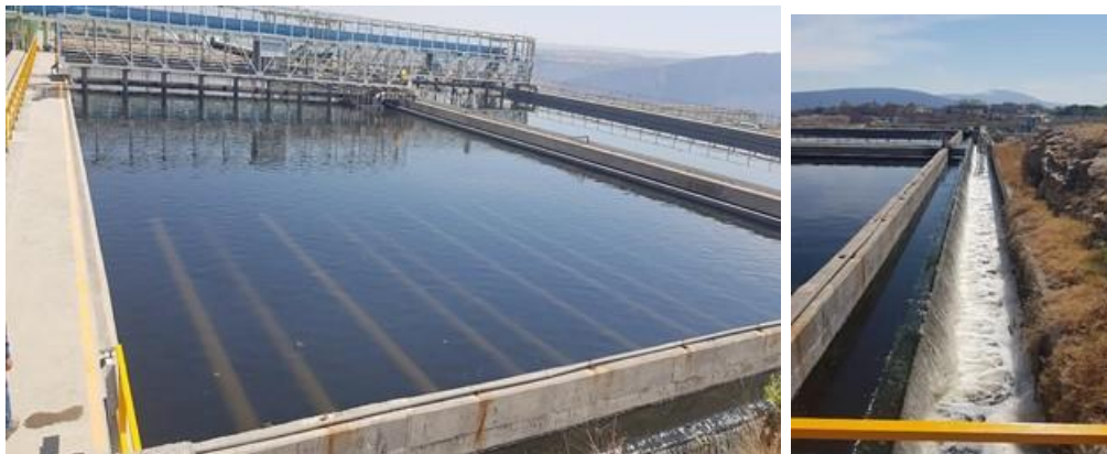
Figura 701. Sedimentador secundario F operando eficientemente
