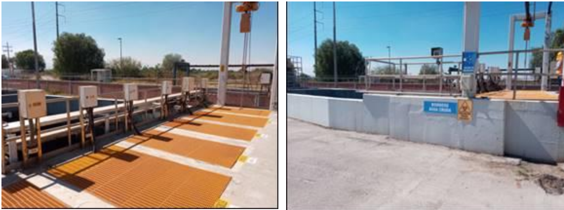
Figura 239. Cárcamo de bombeo.
