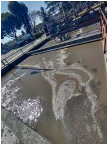
Reactor 8. Presencia de natas
