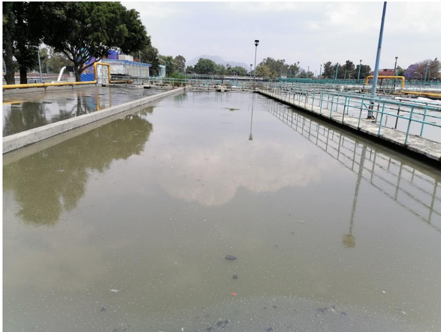
Figura 13 Sedimentadores primarios Sur 9-12
