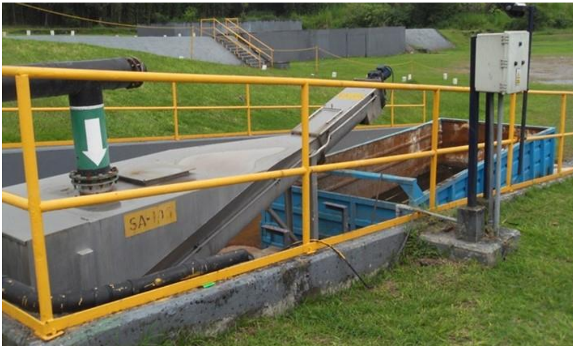
Figura 789. Separador de arenas tipo tornillo (SA-106)
