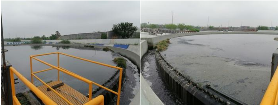
Figura 875. Estado del sedimentador primario 2 y 3
