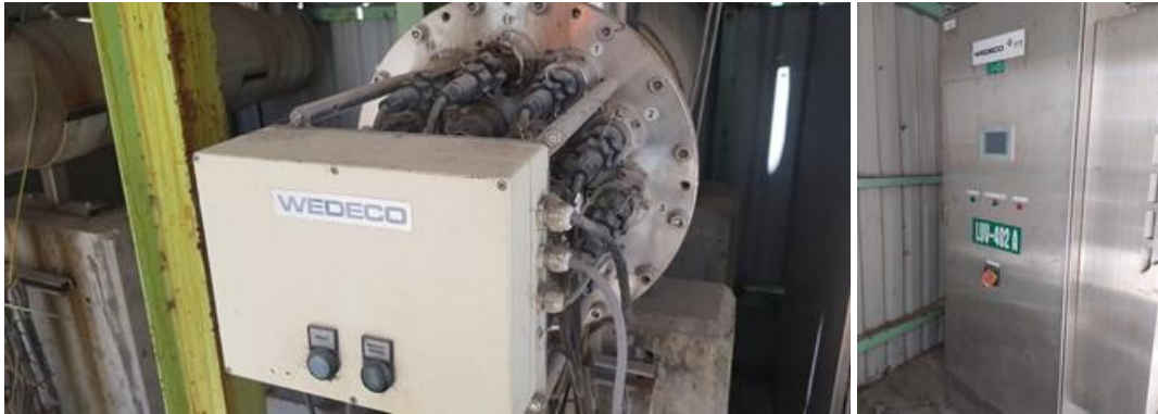
Figura 680. Unidad de desinfección con luz ultravioleta
