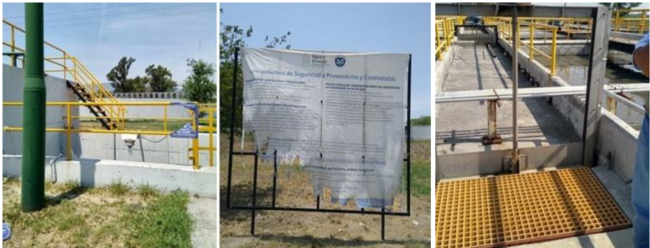
Figura 912. Señalización deteriorada y área sin señalización
