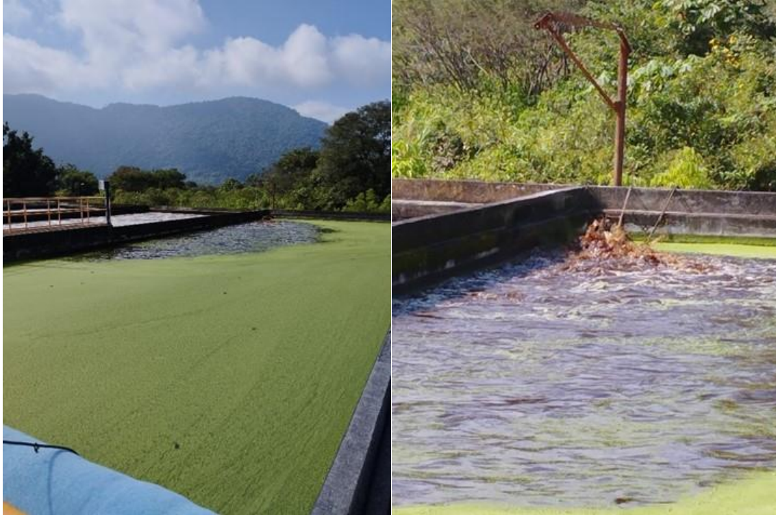
Figura 802. Presencia de vegetación flotante en los reactores de aeración/sedimentación del módulo RAE-301 B.
