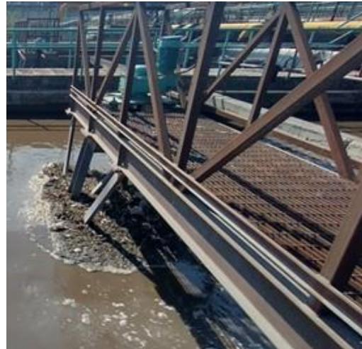
Reactor 10. Presencia de basura
