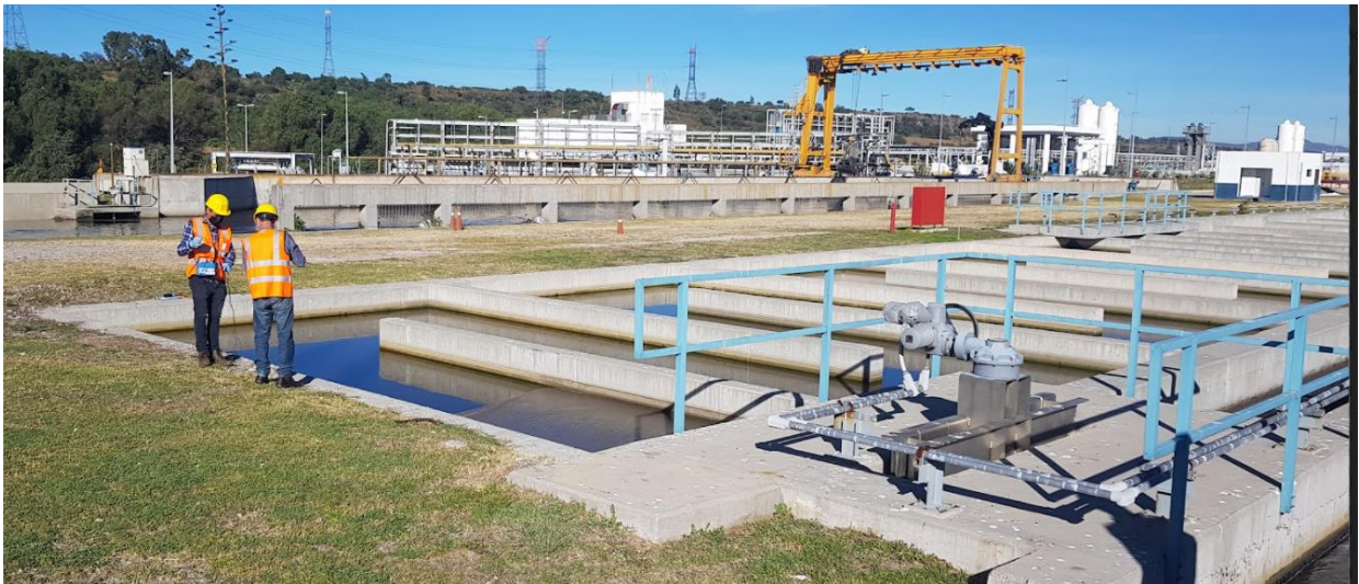
Figura 345. Tanque de cloración
