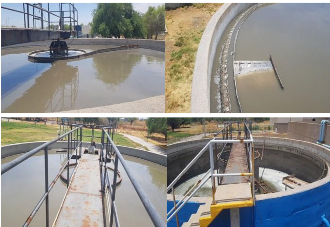
Figura 569. Sedimentadores secundarios de la segunda etapa de oxidación
