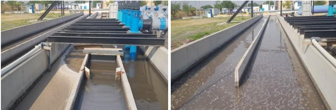
Figura 522. Tanque de contacto de cloro
