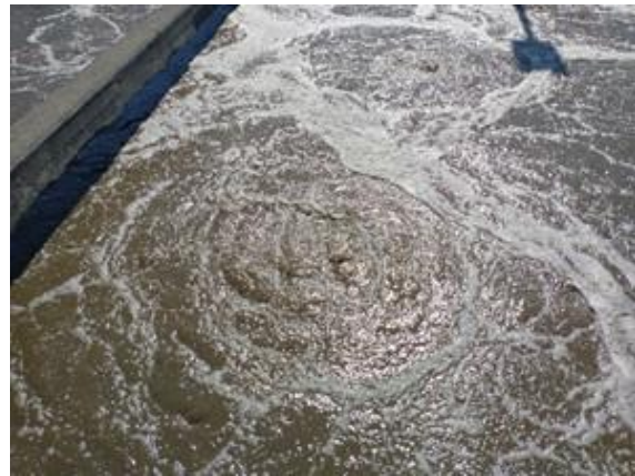
Reactor 8. Difusor dañado
