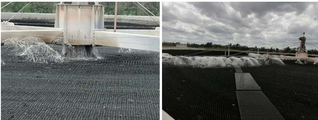
Figura 448. Fugas de agua en biofiltros
