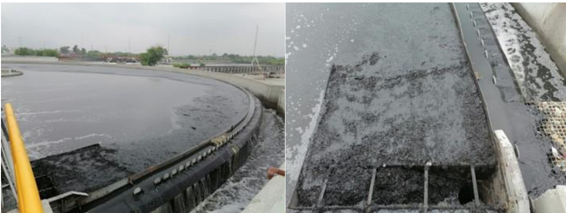
Figura 876. Estado del sedimentador primario 5
