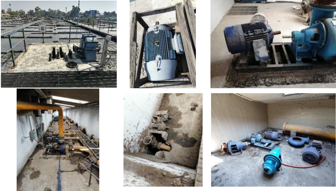
Figura 40 Equipos electromecánicos fuera de servicio
