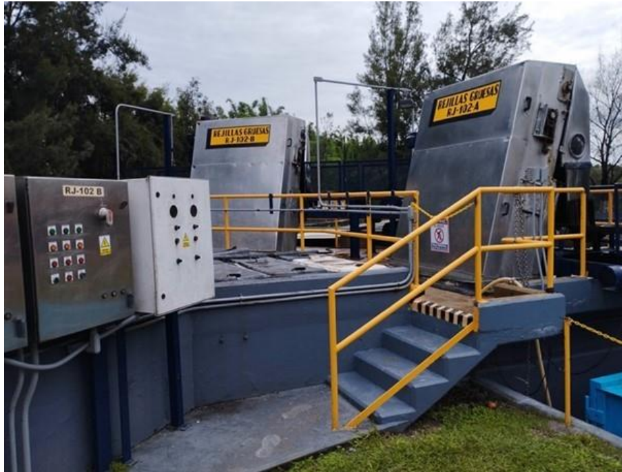
Figura 783. Rejillas gruesas automáticas autolimpiantes
