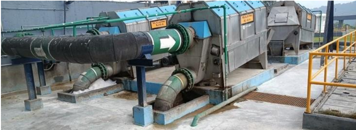
Figura 756. Vista de las rejillas finas tipo tambor.
