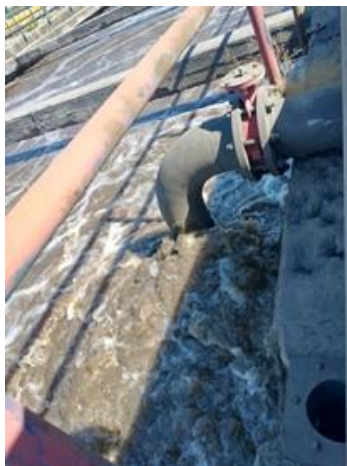
Reactor 7. Fuga de aire
