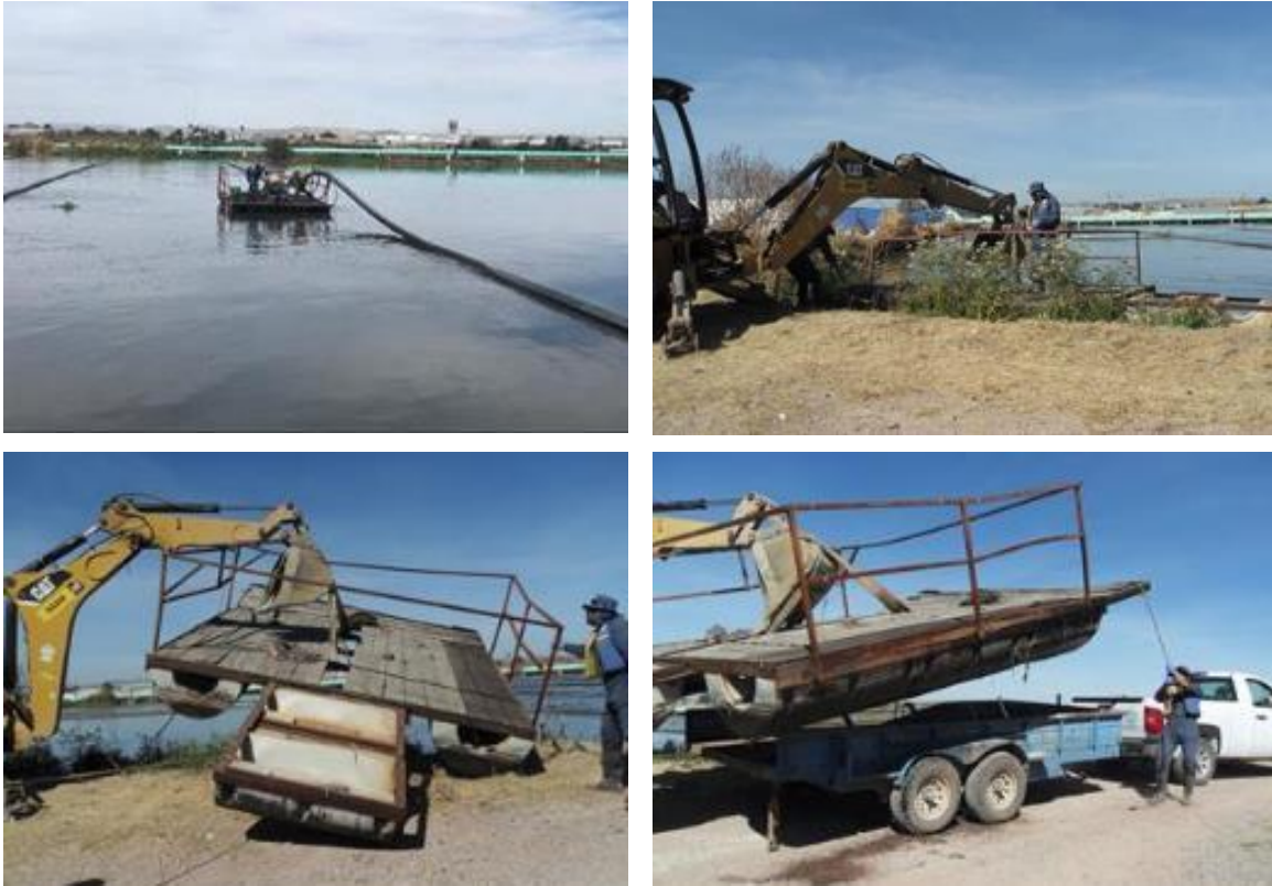
Figura 295. Uso de barcaza para el mantenimiento de las líneas flotantes de distribución de aire
