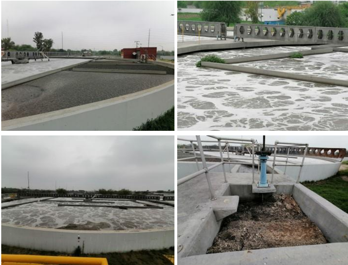
Figura 877. Estado de reactores de lodos activados
