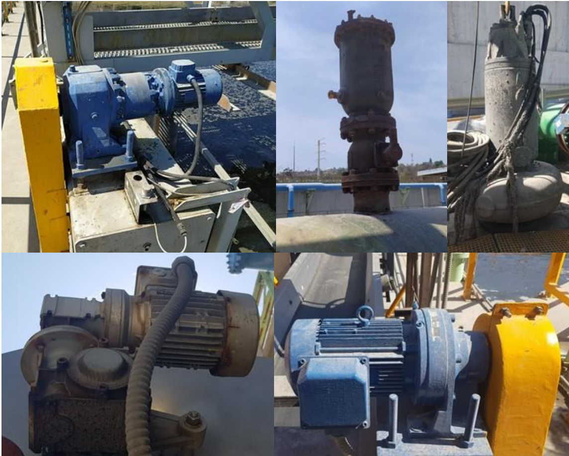
Figura 703. Estado físico de los equipos electromecánicos.
