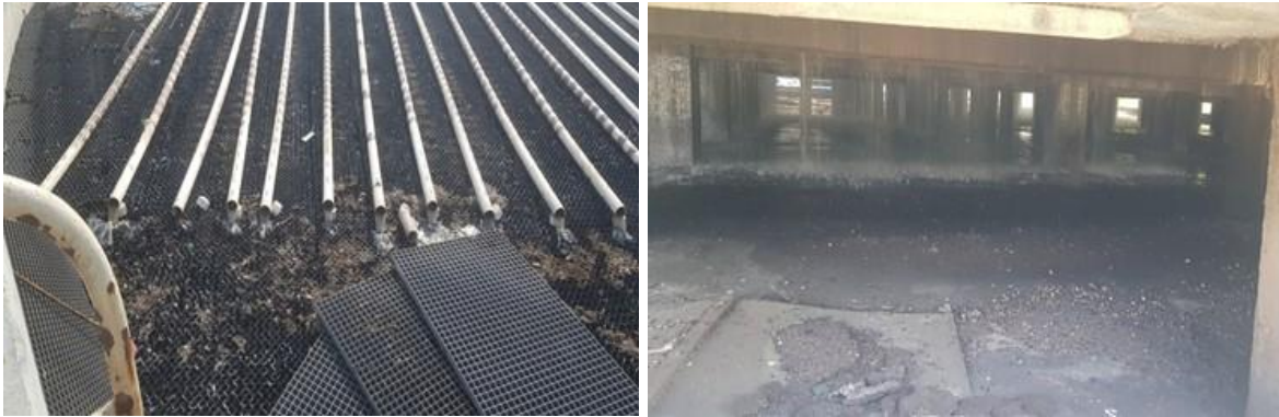
Figura 520. Situación actual de los filtros percoladores
