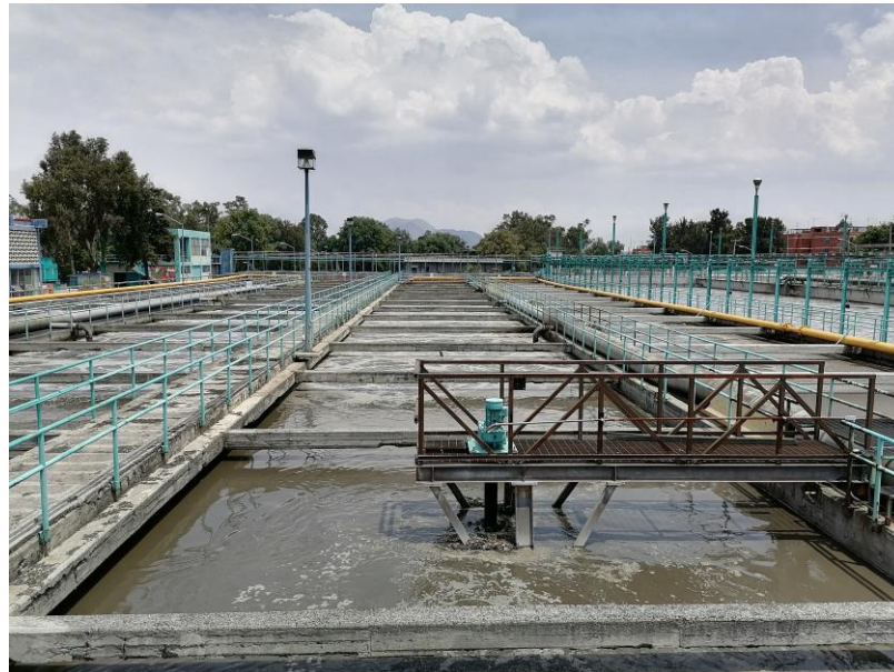
Figura 15 Reactor de lodos activados Sur 9-10
