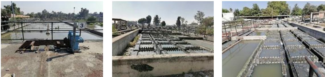
Figura 7 Sedimentadores primarios Norte
