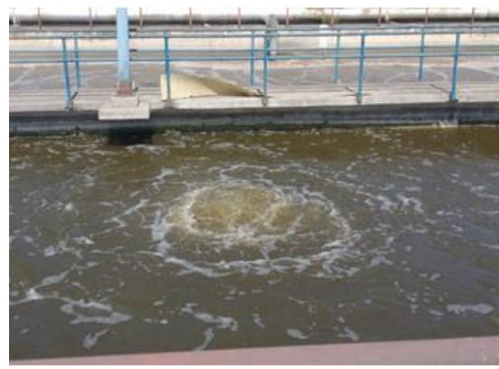
Reactor 3. Difusor dañado
