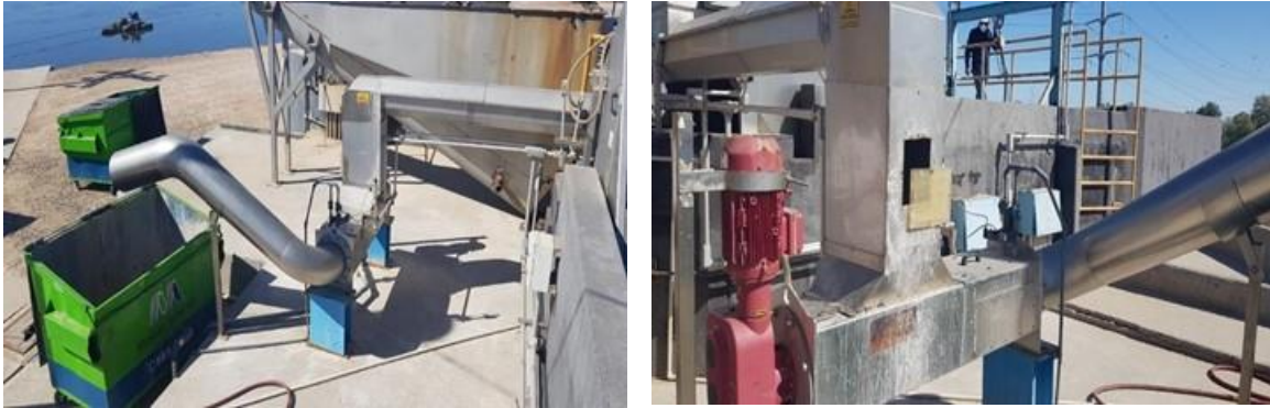
Figura 128. Compactador/lavador de basura de la PTAR Zaragoza
