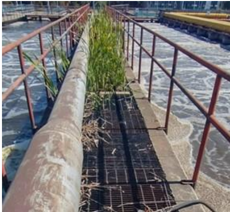
Entre Reactor 5 y 6. Presencia de vegetación
