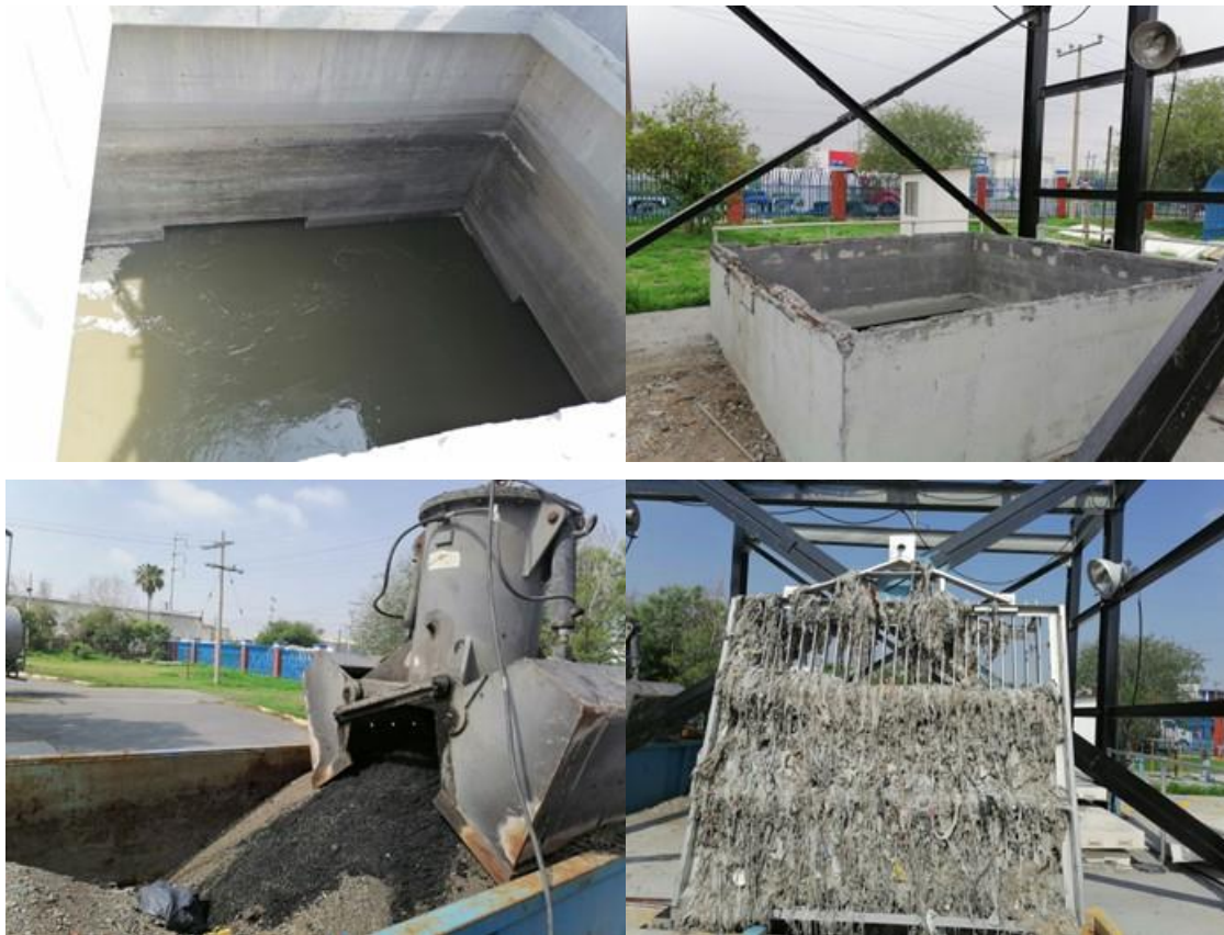
Figura 860 Cárcamo de llegada
