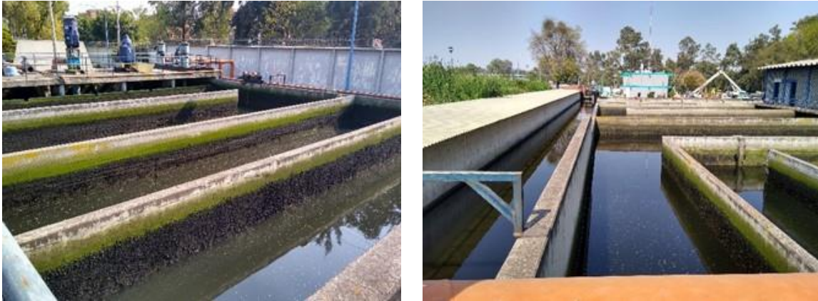
Figura 22 Tanque de cloración general
