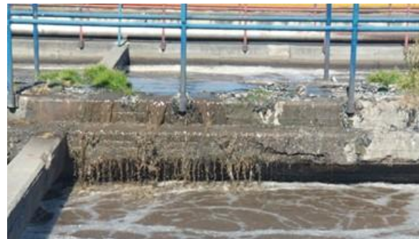
Entre Reactor 6 y 7. Fuga de lodo
