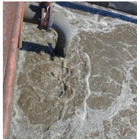
Reactor 5. Fuga de aire
