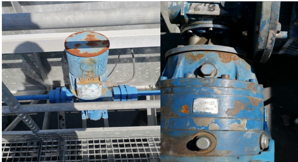
Figura 358. Motor del sedimentador secundario con óxido
