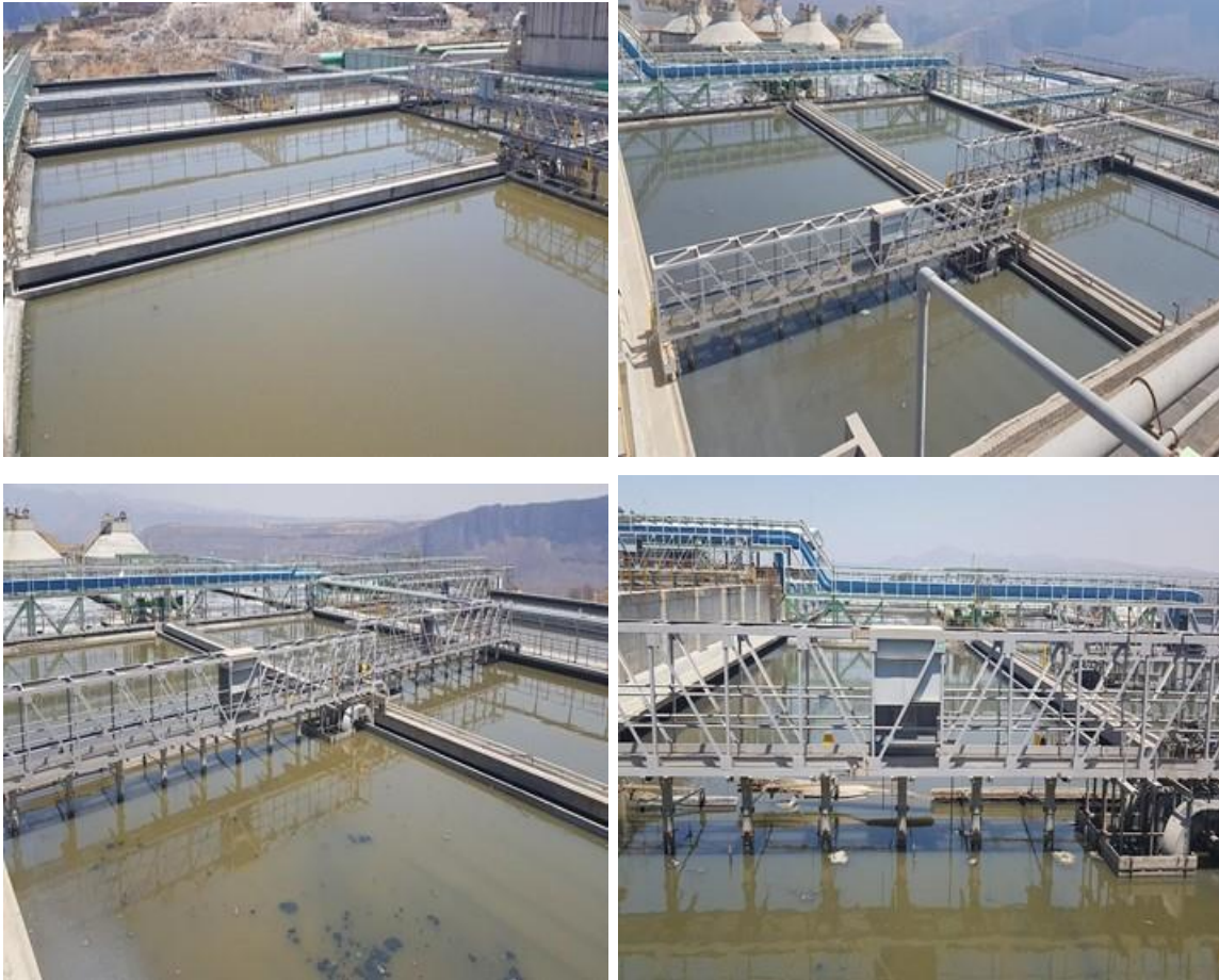
Figura 694. Sedimentadores secundarios operando ineficientemente
