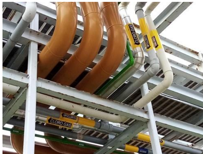
Figura 388. Señales de aplicación del código de colores, señalización y la identificación en las tuberías
