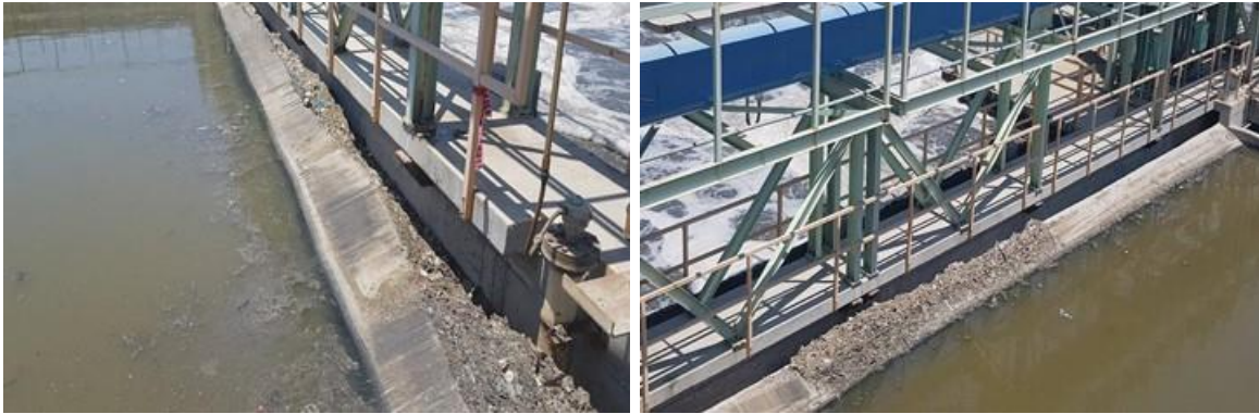
Figura 698. Sólidos acumulados en las entradas de los sedimentadores secundarios
