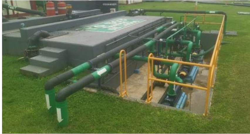
Figura 754. Tanque de lodos TQ-503.
