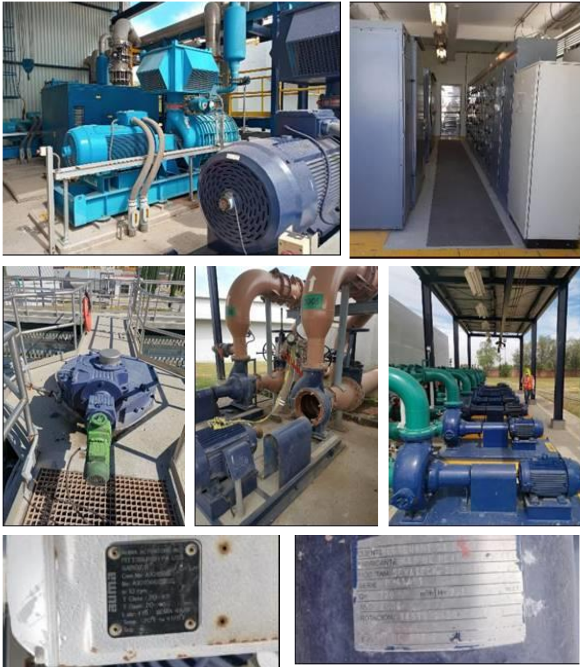
Figura 251. Equipos, tableros CCM y placas de equipos.
