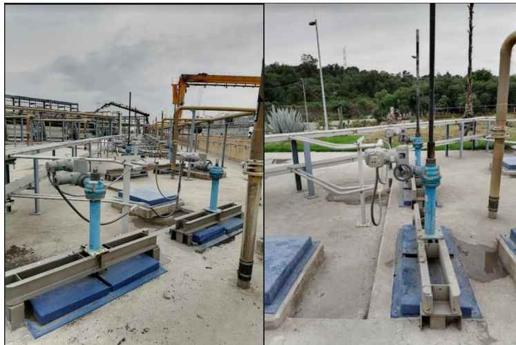
Figura 336. Compuertas de entrada de los canales
