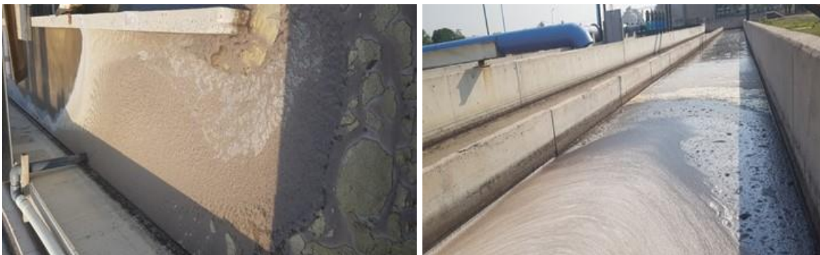
Figura 523. Presencia de natas y espumas en el tanque de contacto de cloro
