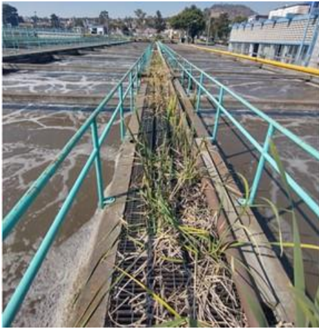
Entre Reactor 10 y 9. Presencia de vegetación
