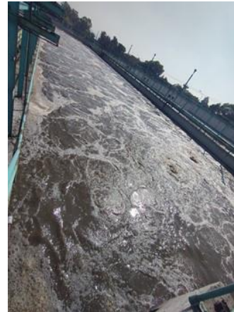
Reactor 13. Difusores dañados
