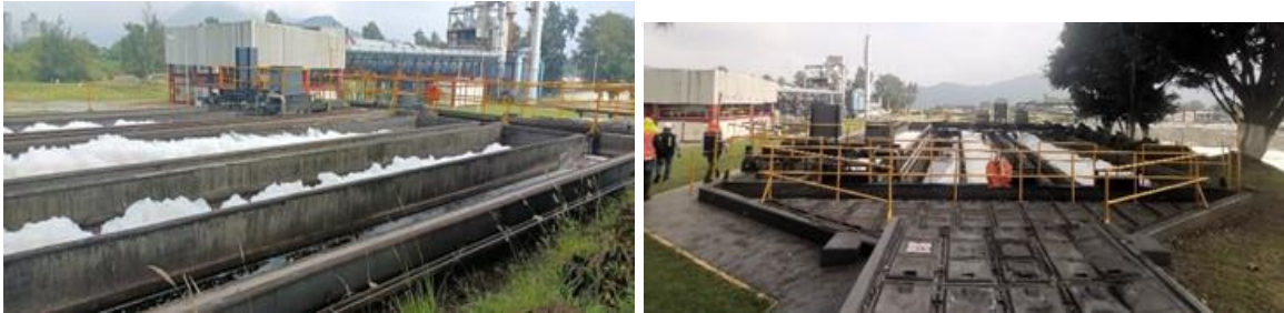
Figura 749. Vista de los desarenadores aireados.
