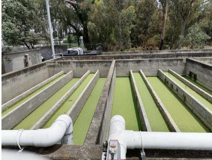
Figura 12 Filtros de arena Norte
