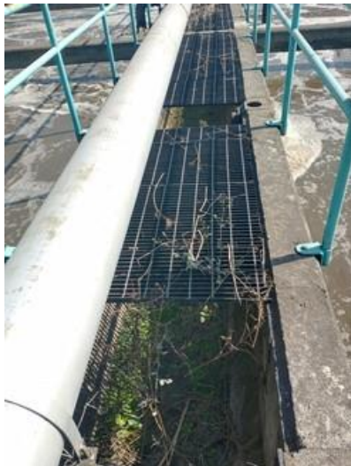
Entre Reactor 11 y 12. Falta de rejillas
