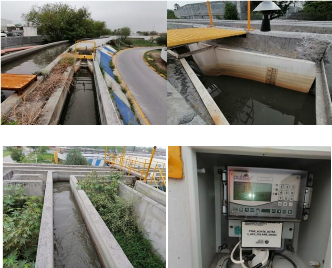
Figura 867. Canal de distribución
