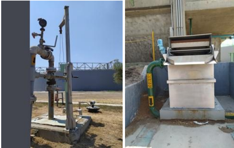
Figura 621. Tanque de grasas y aceites fuera de operación
