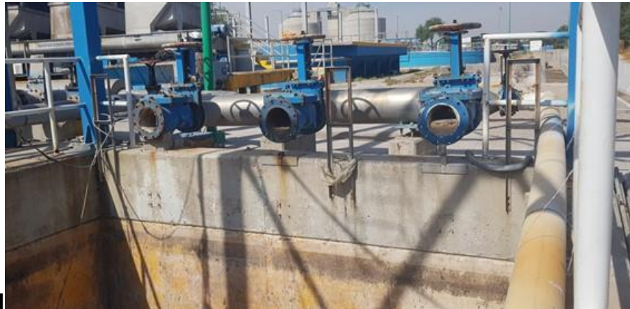
Figura 557. Equipos de bombeo fuera de operación
