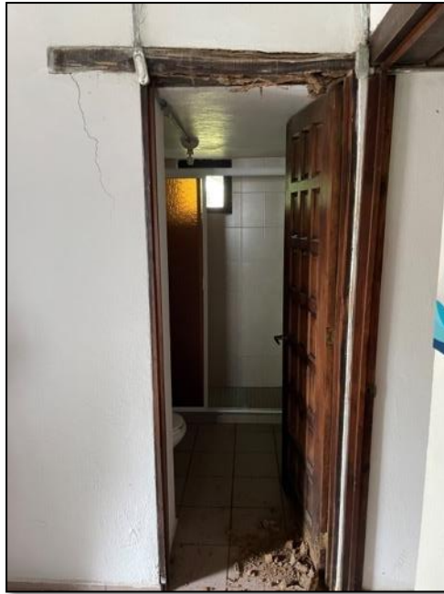
Figura 1. Viga de madera dañada sobre la puerta del baño
