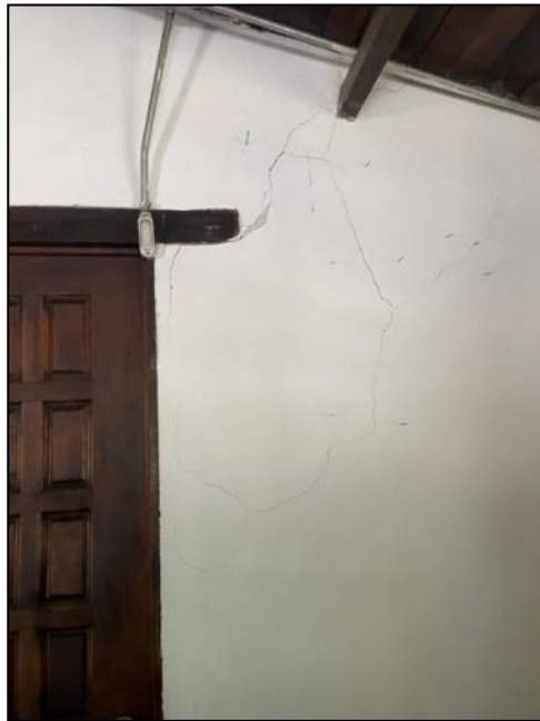
Figura 19. Muro de acceso a cuarto agrietado.
