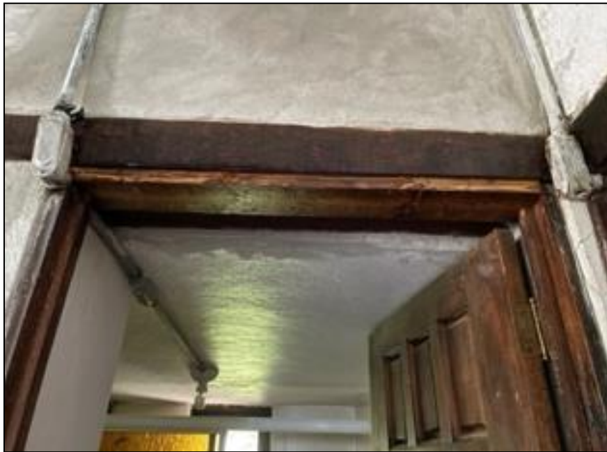
Figura 18. Aplanado en muro de adobe sobre la puerta del baño.
