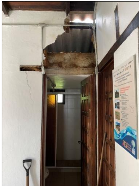
Figura 4. Huevo en muro por retiro de viga y muro de adobe
