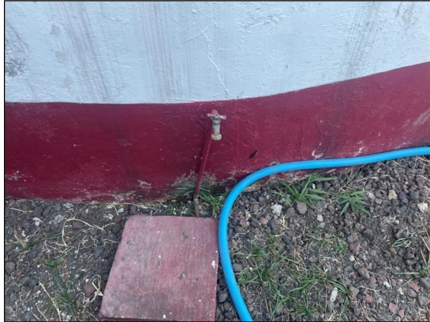
Figura 62. Base de la cisterna con problemas de salitre y posible fuga de agua.
