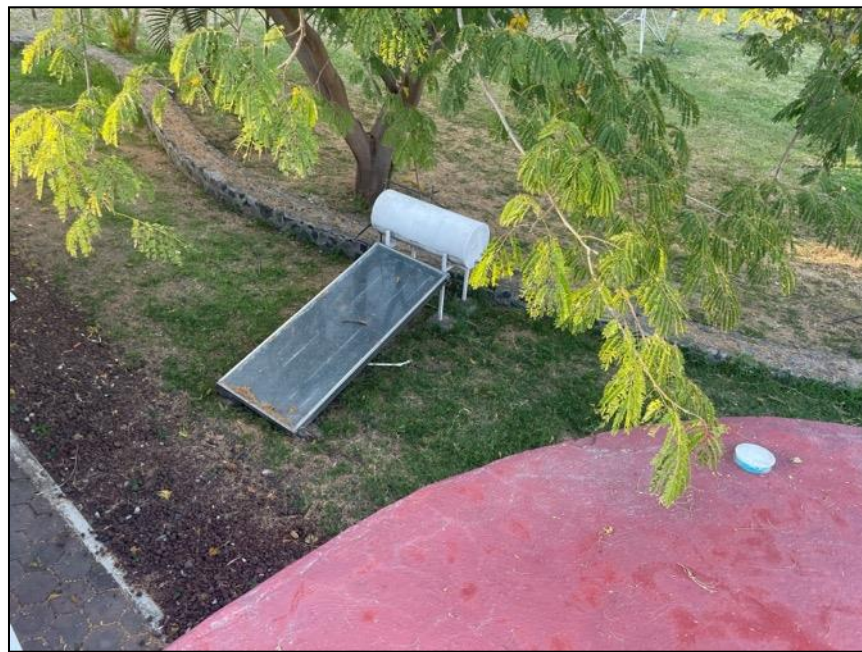
Figura 60. Calentador solar sin funcionar.
