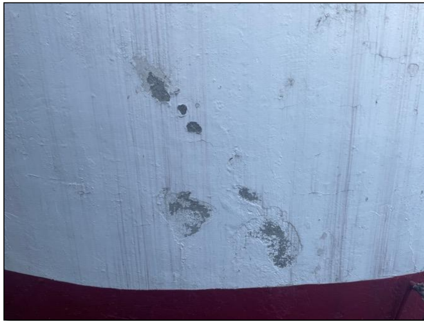
Figura 63. Humedad en muro de la cisterna capuchino
