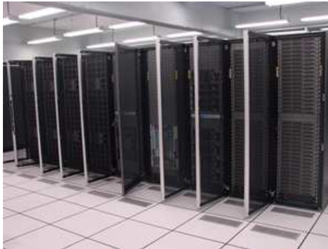
Figura 8.7 – Vista frontal de la segunda línea de racks con puertas abiertas. Tomada de http://www.super.unam.mx/images/stories/HPCP4000_KanBalam/imagenes/kanbalam4.jpg
