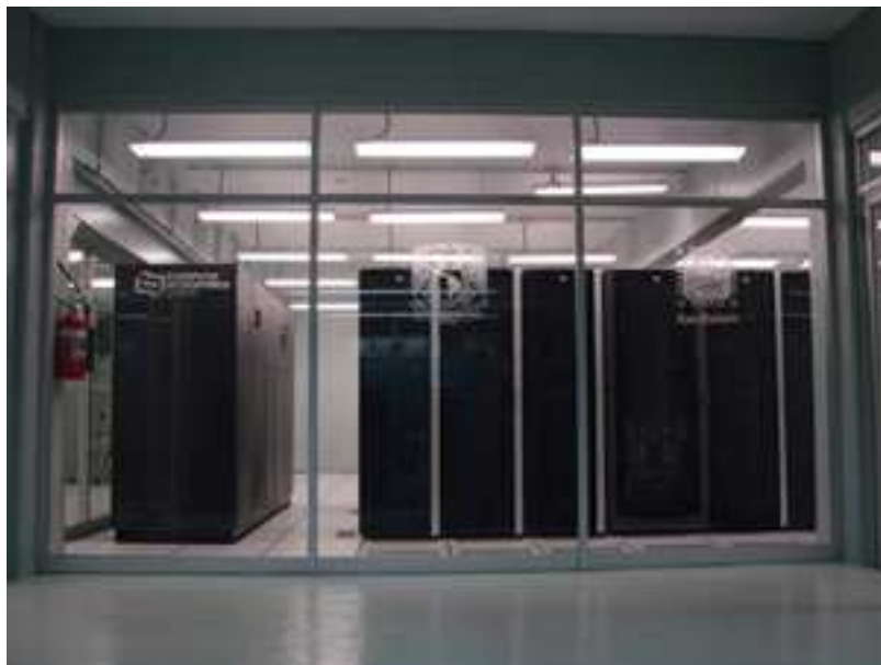
Figura 8.2 – Vista frontal desde el exterior de la sala de máquinas. Tomada de http://www.super.unam.mx/images/stories/HPCP4000_KanBalam/imagenes/kanbalam2.jpg
