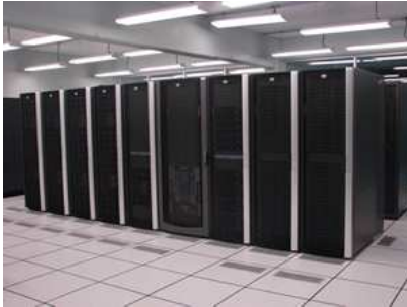
Figura 8.3 – Vista frontal de la segunda línea de racks. Tomada de http://www.super.unam.mx/images/stories/HPCP4000_KanBalam/imagenes/kanbalam3.jpg
