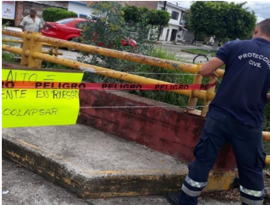
Ilustración 4.18 El puente de la colonia Vicente Estrada Cajigal tuvo que ser demolido para prevenir su desplome y el desbordamiento de la barranca
