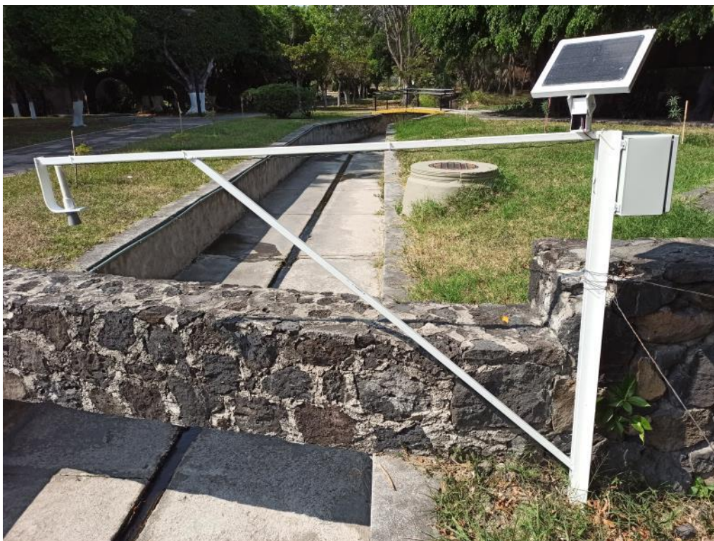
Ilustración 8.8 Sistema de monitoreo de nivel para el punto 2 (Yautepec) instalado en el IMTA
