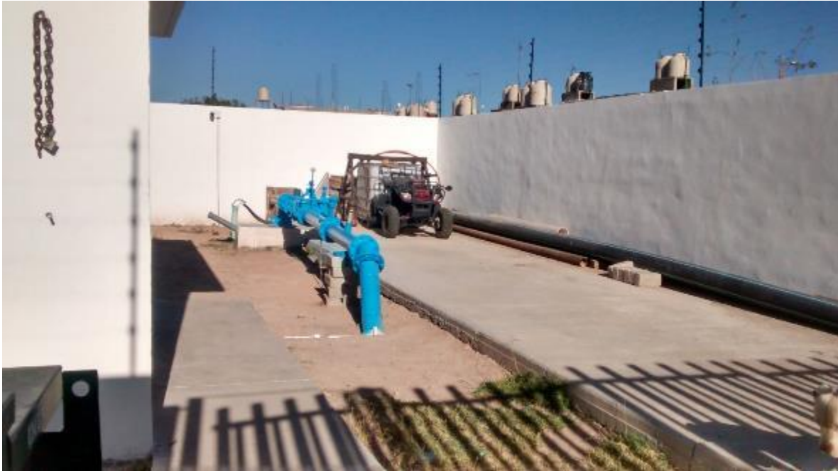
Figura 3.5.7 Pozo de agua potable Fuentes de Balvanera
