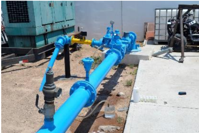
Figura 3.5.20 Muestra 9 Pozo de agua potable Fuentes de Balvanera
