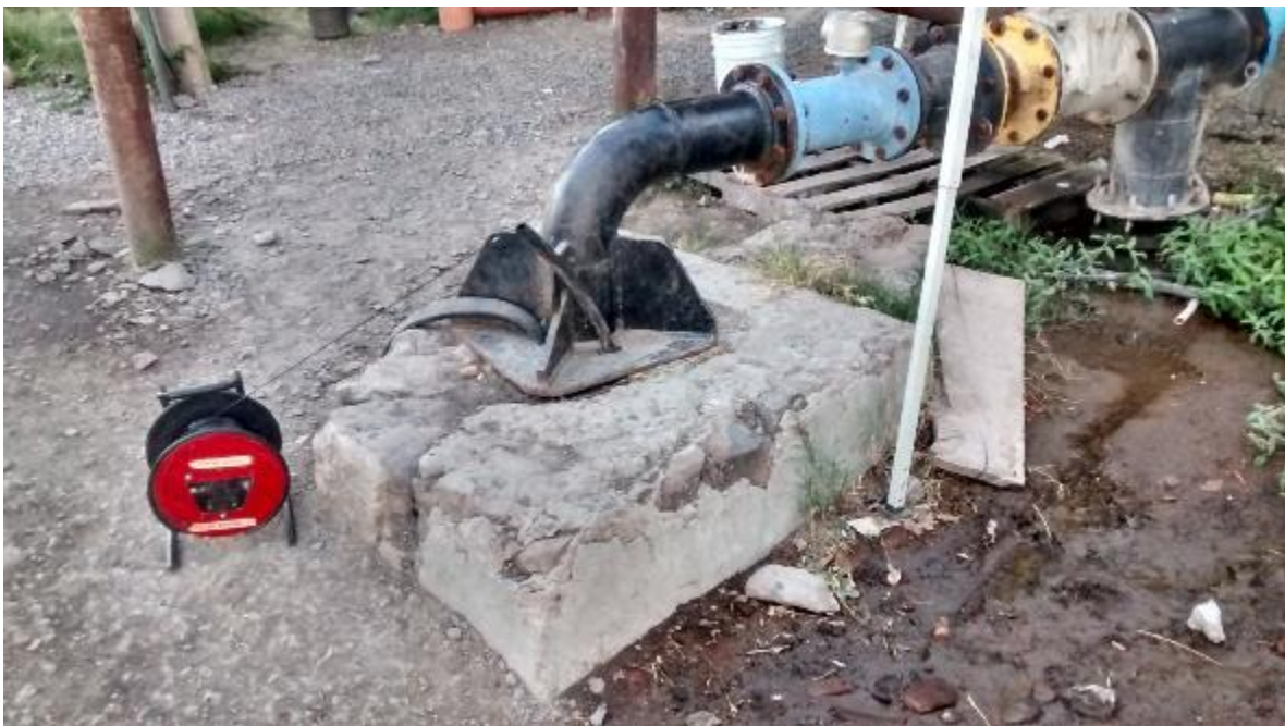
Figura 3.5.8 Pozo de agua potable La Estancia
