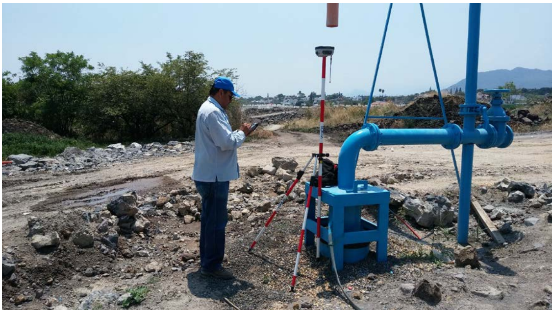
Foto 1 Medición del brocal del pozo Nuevo ARA (Oaxtepec).
