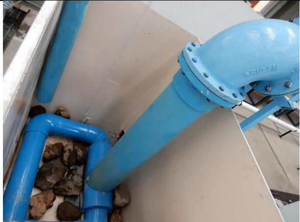
Fotografía. 10. Válvulas de control y conducto de alimentación del flujo
