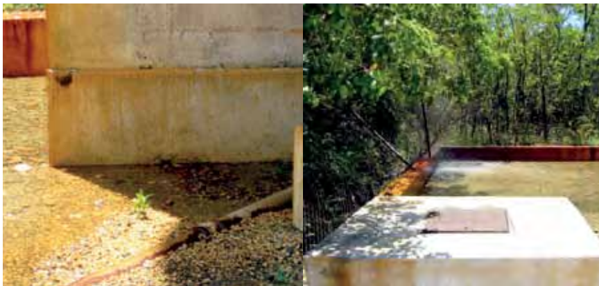
Instalaciones deterioradas del tanque de almacenamiento de agua potable de San Felipe Foto: Ricardo López, Investigador IMTA
