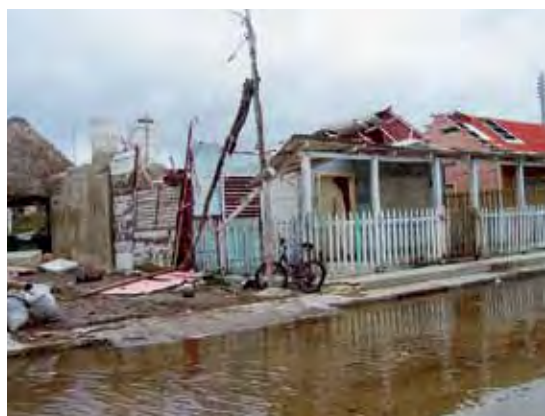
Destrozos ocasionados por el huracán en San Felipe Foto: Protección Civil de San Felipe
