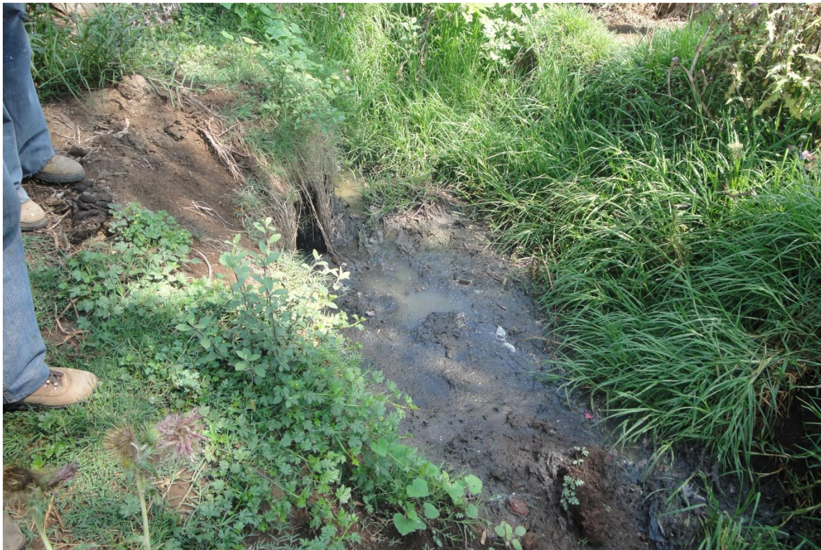
Ilustración 16. Descarga de agua residual en el libramiento Pátzcuaro-Erongarícuaro.
