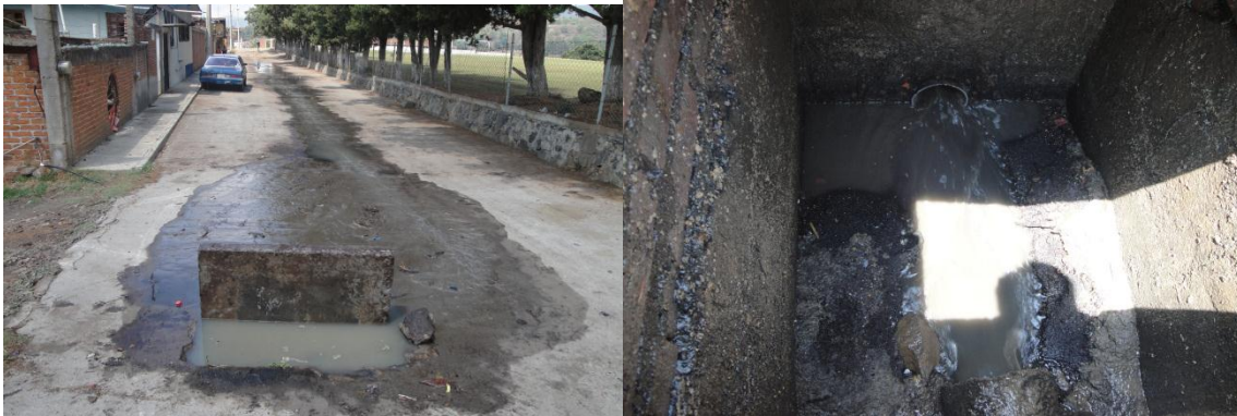
Ilustración 17. Obstrucción en la reducción de diámetro de 18 a 8 pulgadas.
