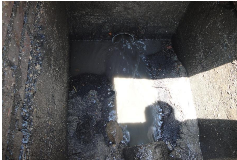
Ilustración 9. Pozo de visita con reducción de tubo de 18 a 8 pulgadas.
