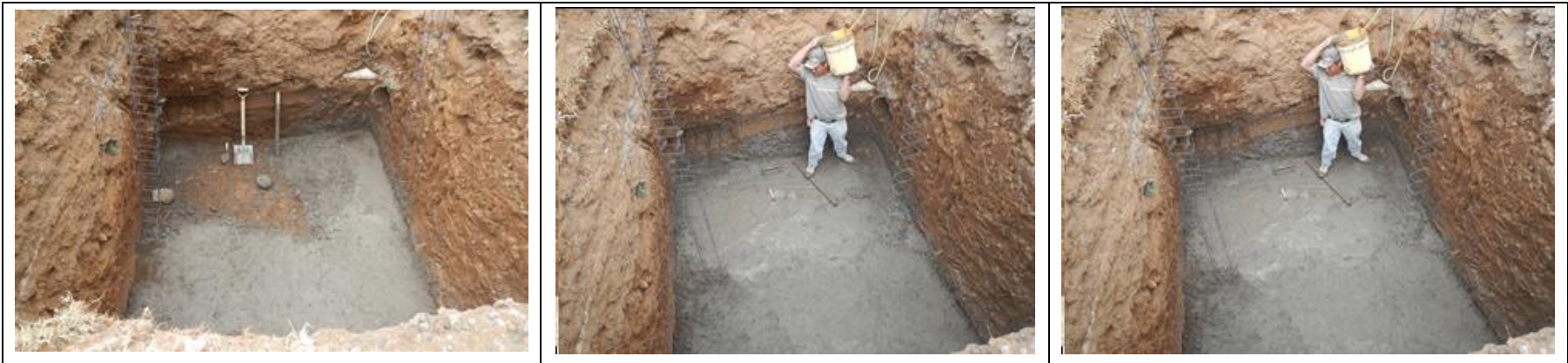
Ilustración 46 Plantilla de Concreto Reforzado de 8 cm de Espesor con f'c=250 \text{ kg/cm}^2
