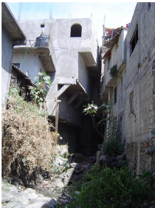
Figura 22.4. Invasión de la zona Federal en la zona norte de la barranca de Amanalco.
