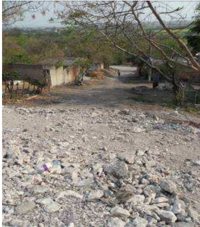
Figura 19. Calle Lauro Ortega, sin drenaje y pavimentación.
