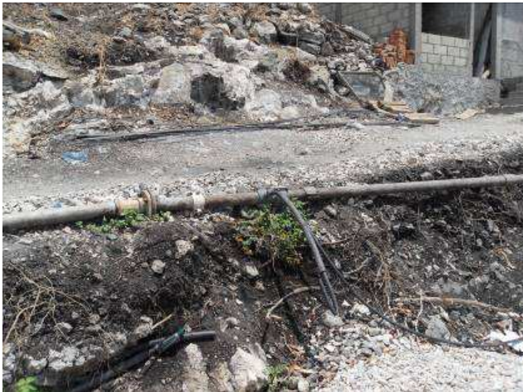
Figura 12. Tubería de agua potable y mangueras.
