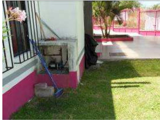
Figura 2.4. Bomba del CDC.
