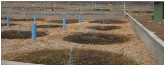
Fotos 6 a 8.-Sistema de vermifiltración Tohá
