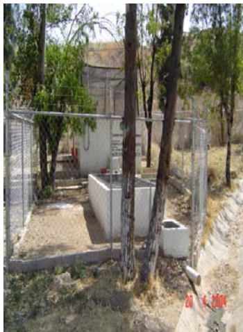
Foto 9.-Planta de tratamiento condominio descarga a lago recreacional Q = 0.125 \text{ L s}^{-1}
