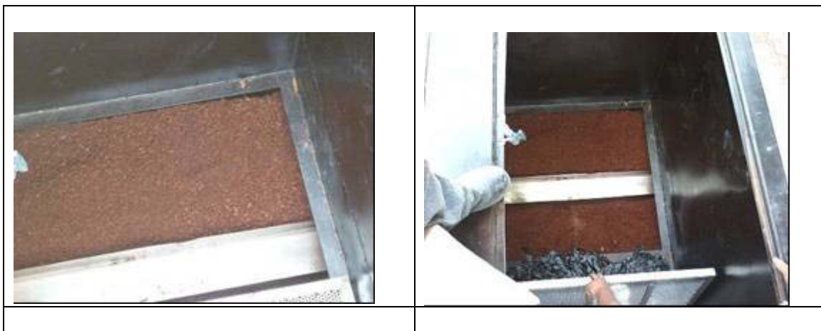
Fotos 22 y 23.-Empaque de tezontle en vermifiltros unifamiliar
