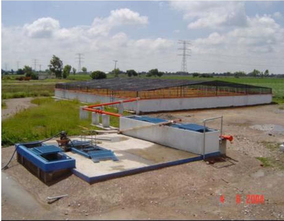
Foto 12.-Planta de tratamiento de aguas residuales para fraccionamiento capacidad de tratamiento Q = 16 \text{ L s}^{-1}
