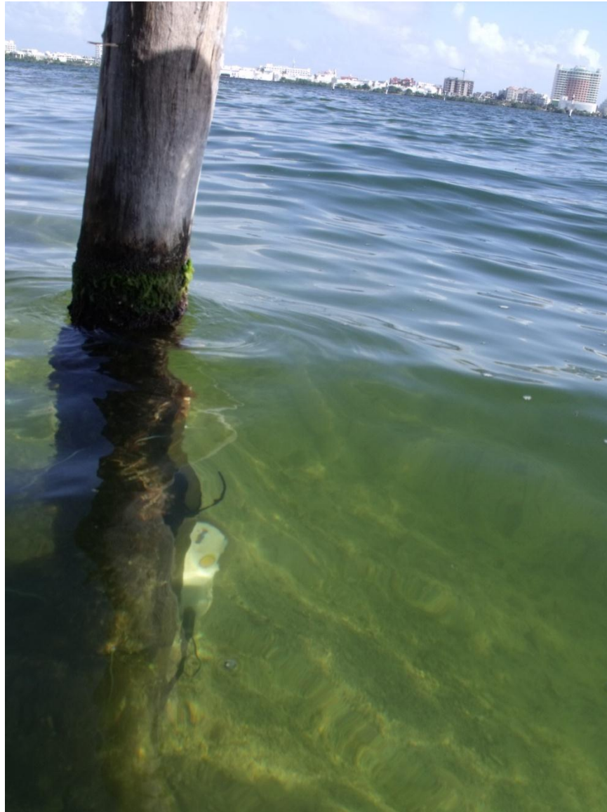
Figura 5.2.5 Perfilador doppler lateral SL de 3 MHz instalado en la entrada del canal sur de la laguna de Bojórquez en Cancún, QR
