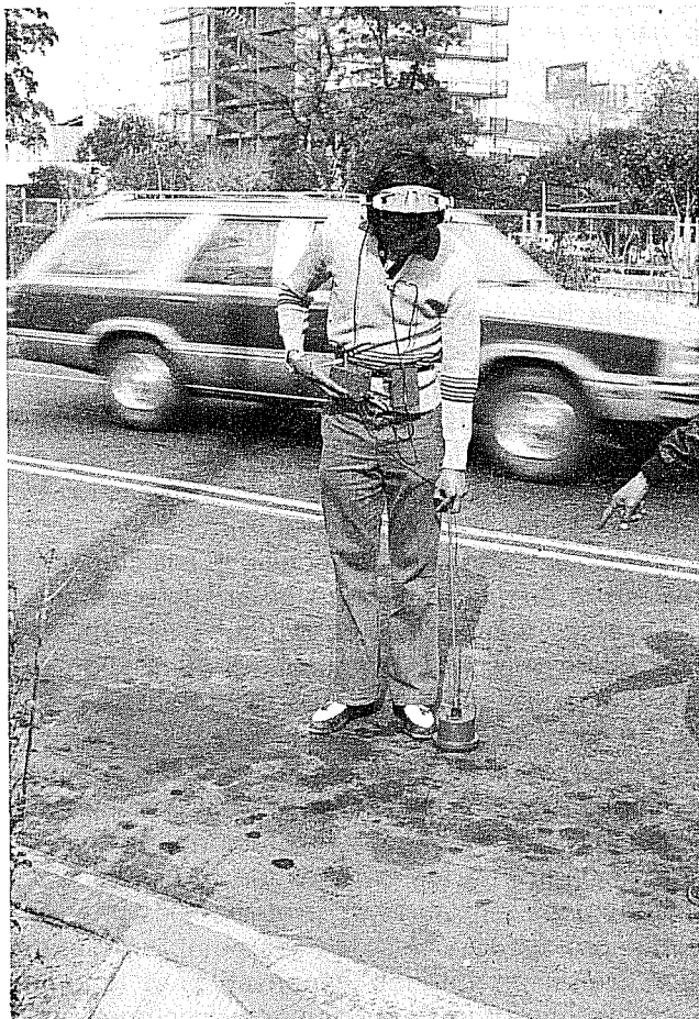
Detección de fugas no visibles
