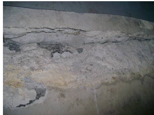
Dimensionamiento de la falla estructural, Se recomendó llenar el tanque a media capacidad, hasta que se sustituyera por el tanque nuevo.
