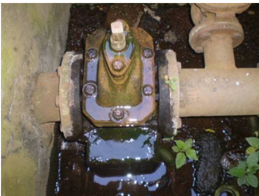
Válvula con fuga en tanque principal
