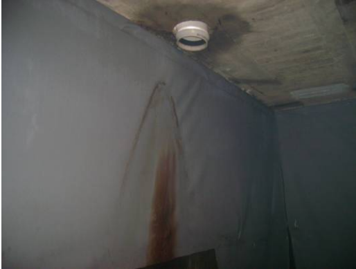
Deterioro de la geomembrana causada por la forma de operar el tanque (llegada del flujo).
