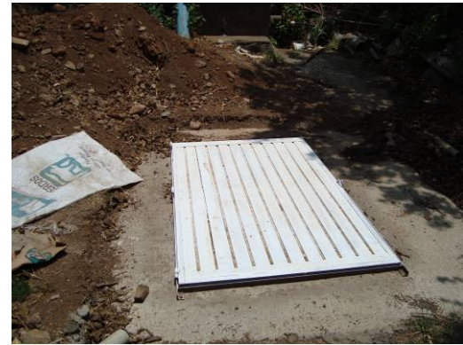
Estación de Aforo terminada con tapa y candado
