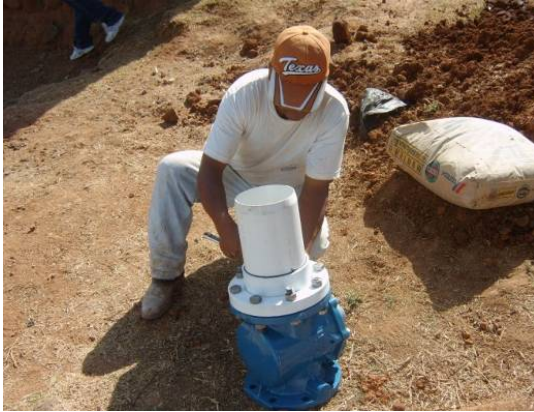
Piezas especiales y macromedidor
