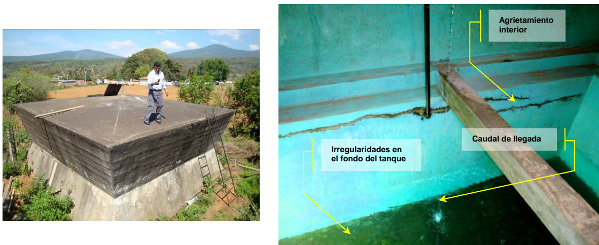
Fotografía 2.6 Vista del tanque secundario "La Loma" y fallas estructurales.
