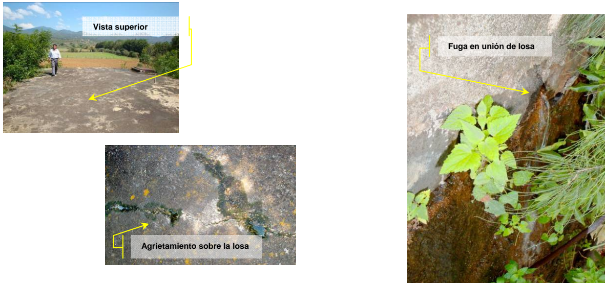
Fotografía 2.5 Vistas del tanque principal "La Loma" y fallas estructurales.
