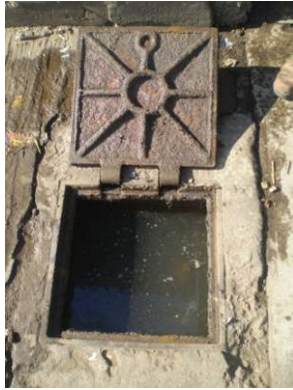
Válvula con fuga en Morelos y Salazar
