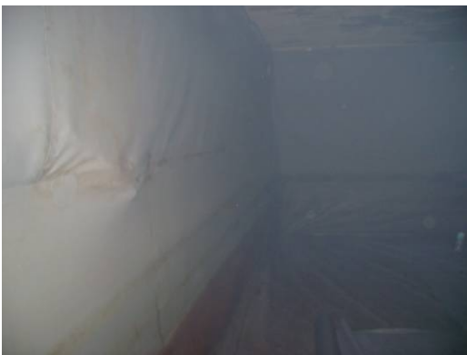
Desprendimientos de materiales causados por la falla estructural y ruptura de geomembrana.
