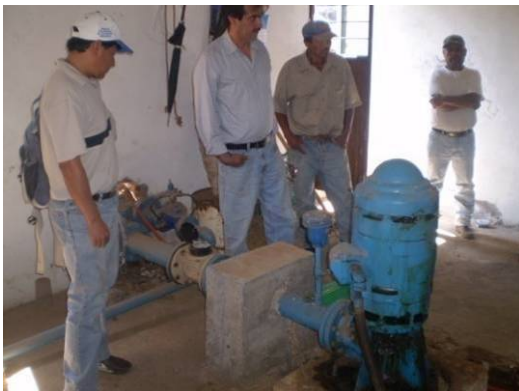
Equipo de bombeo y medición del manantial
