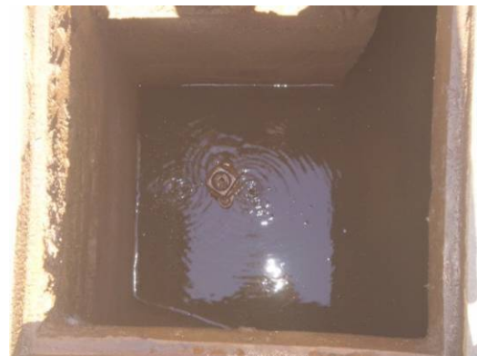
Válvula con fuga y registro inundado
