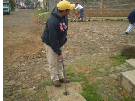
Verificación de movimientos de válvulas
